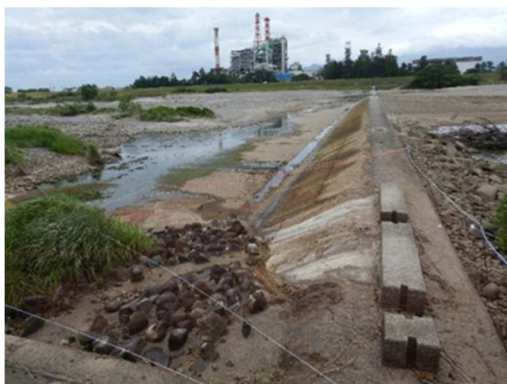
図 19 日野川下流部で発生した瀬切れ (2019 年 5 月 20 日 日野川車尾堰周辺)
