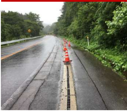
【国道179号】舗装陥没(三朝町木地山)
