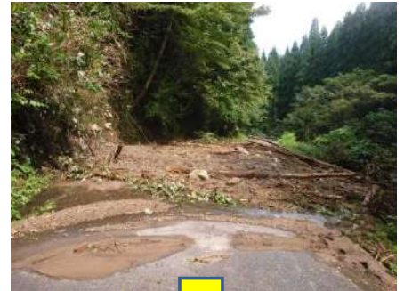
【県道下見関金線】 土砂崩落(倉吉市上大立)
