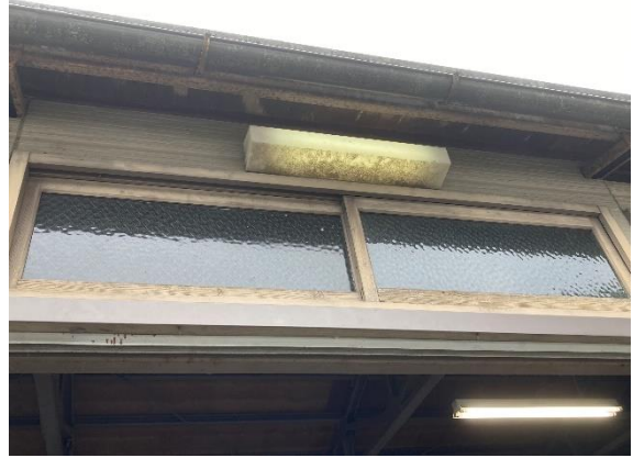
【b 水防倉庫入口照明】
