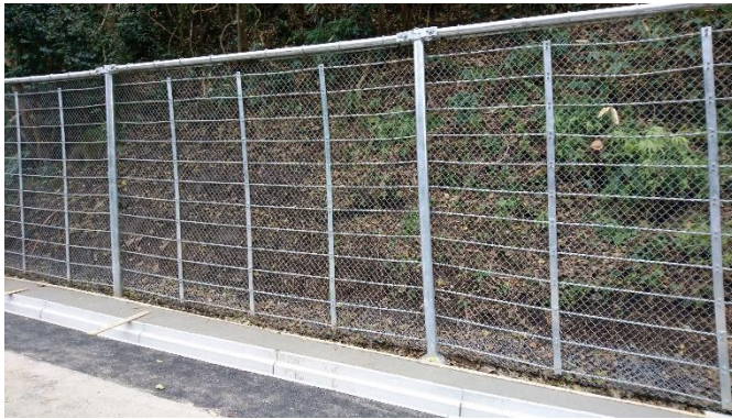
【西伯根雨線 落石防護柵】
