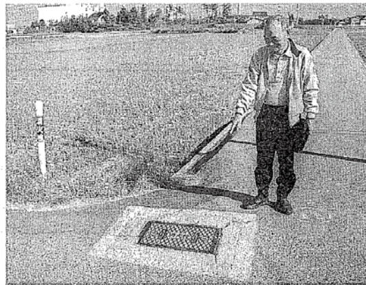
送水パイプが破損し、水圧が下がった消火栓 米子市夜見町
