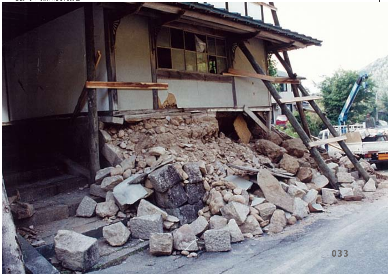
地震によって崩れ落ちた石垣
