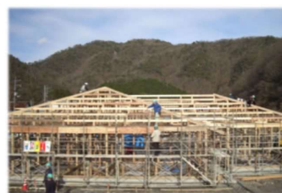
非住宅建築物
