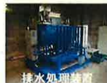
排水処理施設
