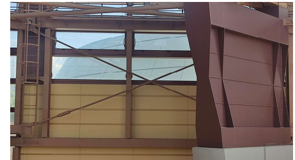
▲不具合箇所の拡大。開放操作を行っても排煙窓が開放しない状態となっている。
