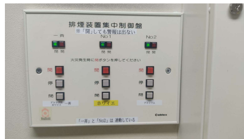
▲排煙装置集中制御盤 (防災センター設置) 火災時の煙の排出を目的として、電動式自然排煙窓が大ホール4階ホワイエ (2区画) 及びアトリウム (6区画) に設置されており、これらは排煙装置集中制御盤により操作される。現在、当該排煙窓のうち1区画において、電動駆動装置の不具合により正常に開放動作しないことが確認されており、また1区画においてダンパーの劣化が指摘されている。
