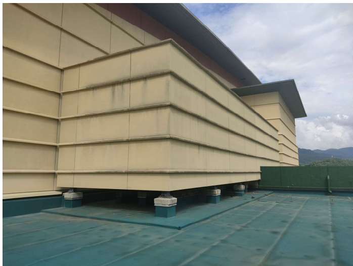
矢印方向から撮影。 空調機は防護壁に囲われている
