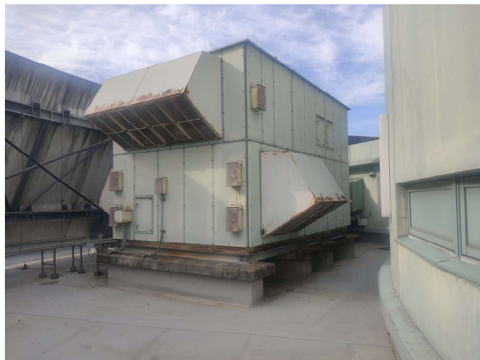
ホール展示系統：AHU-M-1 製造・機種：新晃工業(株) KV-40
