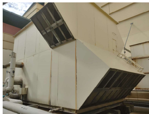
大ホール 2・3 階系統 : AHU-H-2 製造・機種 : ｸﾙﾀ空調 AHR01-43RT
