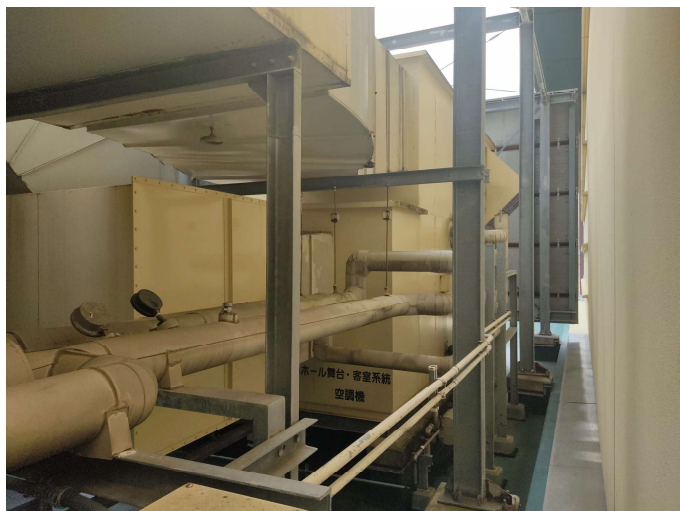
小ホール系統：AHU-H-5 製造・機種：株式会社空調 AHRE5-43RT
