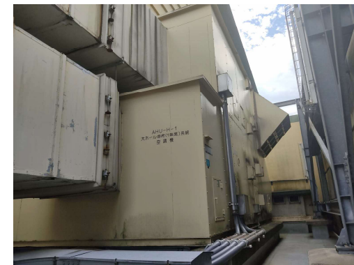
大ホール 1 階系統 : AHU-H-1 製造・機種 : ｸﾙﾀ空調 AHRE7-71RT
