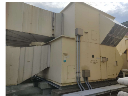
大ホール 舞台系統 : AHU-H-3 製造・機種 : ｸﾙﾀ空調 AHR01-65RT
