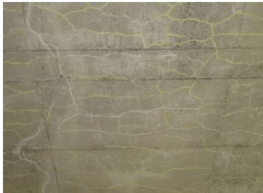
【本体工（頂版）：ひびわれ、健全性Ⅱ】
