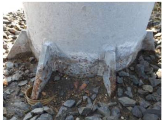
【支柱基礎：腐食、健全性Ⅲ】
