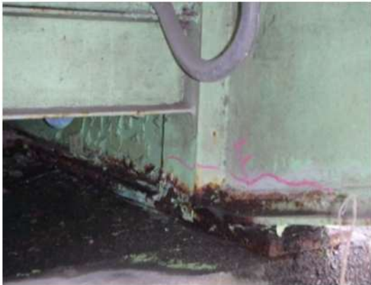
【上部工（主桁）：腐食、健全性Ⅲ】
