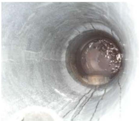
【支柱内部：滞水、健全性Ⅱ】
