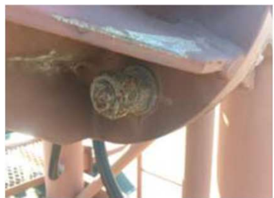
【横梁取付部：腐食、健全性Ⅱ】
