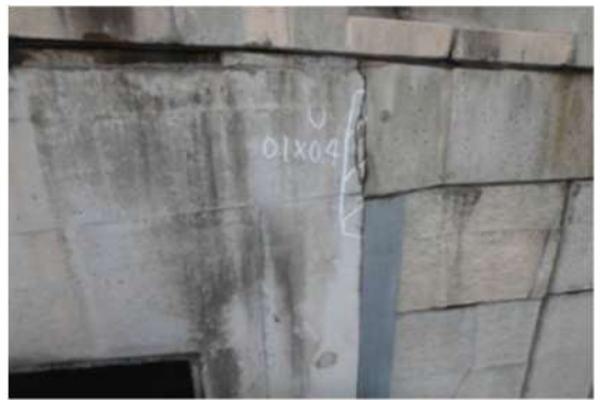
【翼壁部（ウイング）：うき、健全性Ⅲ】
