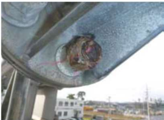
【横梁（標識板取付部）：腐食、健全性Ⅲ】
