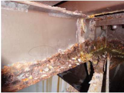
【横梁：腐食、健全性Ⅲ】
