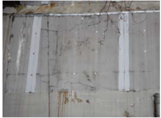
【下部工（山側受台）：アルカリ骨材反応の疑いがあるひび割れ、健全性Ⅲ】
