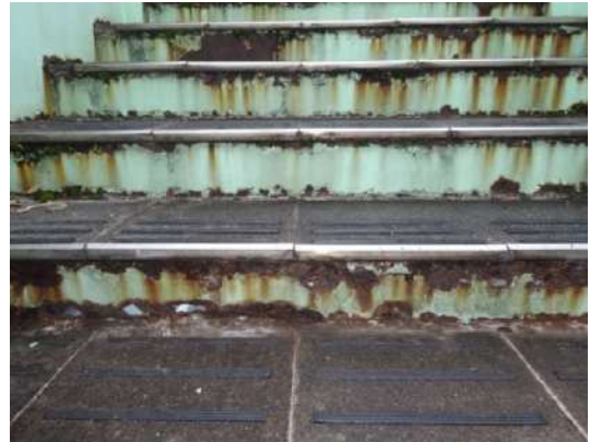
【階段部（蹴上）：腐食、健全性Ⅱ】
