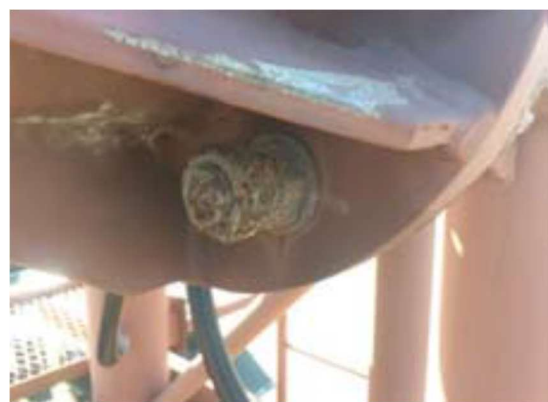
【横梁取付部：腐食、健全性Ⅱ】
