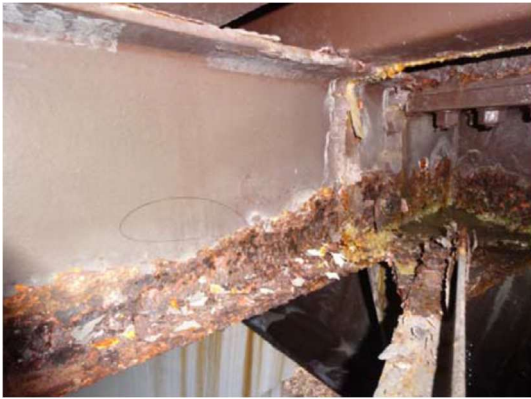
【横梁：腐食、健全性Ⅲ】
