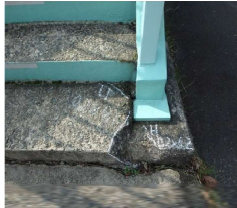
【下部工（橋台）：うき、健全性Ⅲ】
