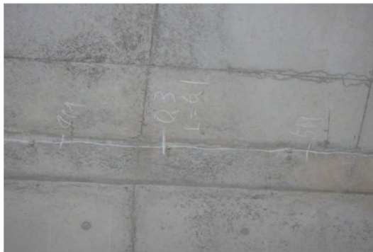
【本体工（頂版）：ひび割れ、健全性Ⅱ】
