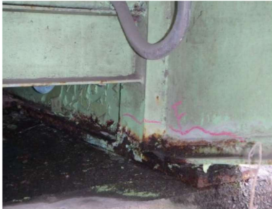
【上部工（主桁）：腐食、健全性Ⅲ】
