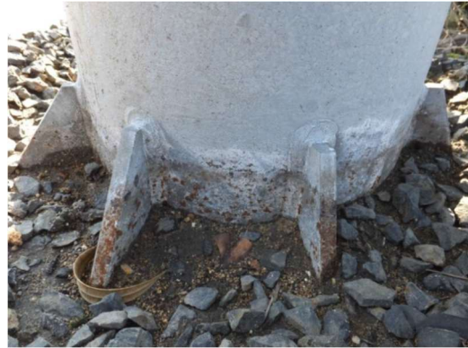
【支柱基礎：腐食、健全性Ⅲ】
