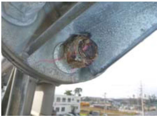
【横梁（標識板取付部）：腐食、健全性Ⅲ】
