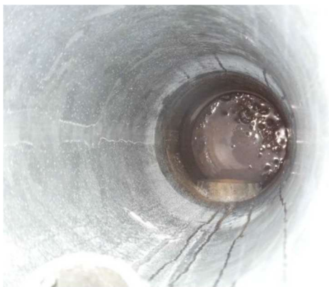
【支柱内部：滞水、健全性Ⅱ】
