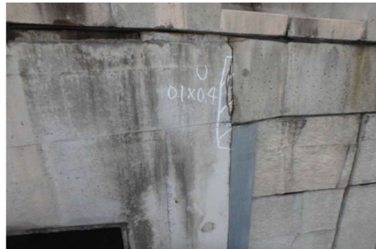
【翼壁部（ウイング）：うき、健全性Ⅲ】
