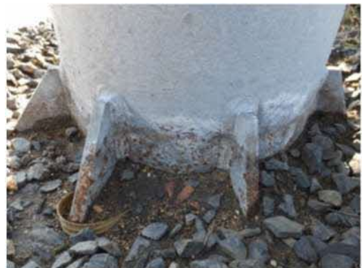
【支柱基礎：腐食、健全性Ⅲ】
