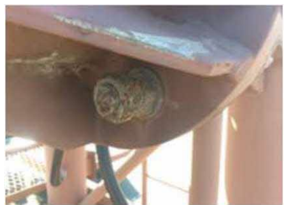
【横梁取付部：腐食、健全性Ⅱ】
