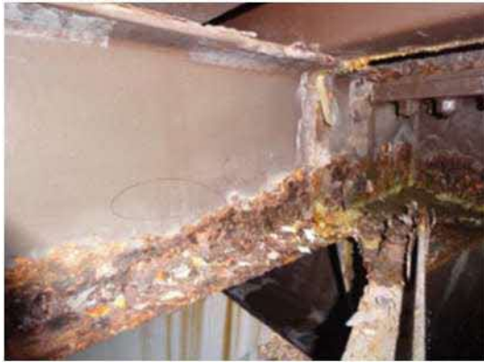
【横梁：腐食、健全性Ⅲ】
