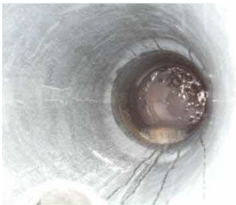
【支柱内部：滞水、健全性Ⅱ】
