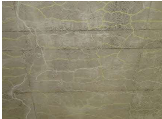
【本体工（頂版）：ひびわれ、健全性Ⅱ】
