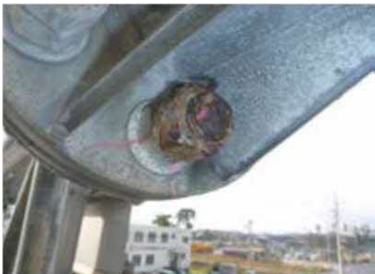
【横梁（標識板取付部）：腐食、健全性Ⅲ】
