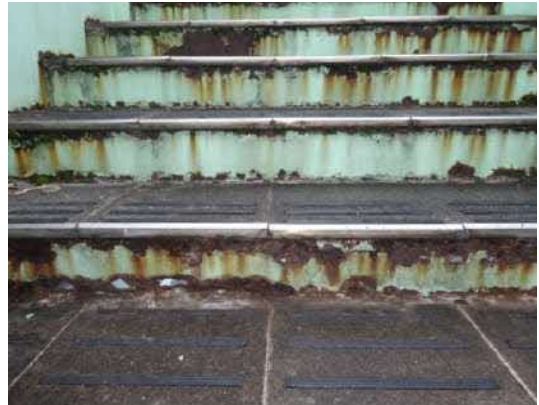
【階段部（蹴上）：腐食、健全性Ⅱ】
