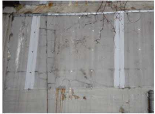
【下部工（山側受台）：アルカリ骨材反応の疑いがあるひび割れ、健全性Ⅲ】
