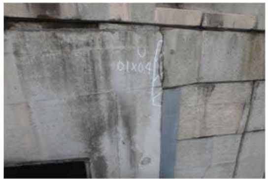
【翼壁部（ウイング）：うき、健全性Ⅲ】
