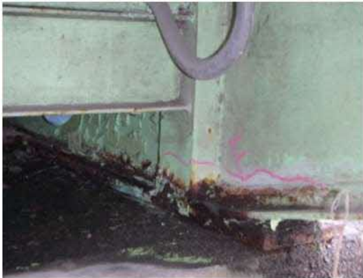
【上部工（主桁）：腐食、健全性Ⅲ】
