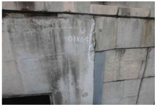
【翼壁部（ウイング）：うき、健全性Ⅲ】
