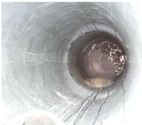
【支柱内部：滞水、健全性Ⅱ】
