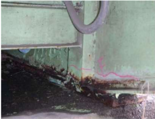
【上部工（主桁）：腐食、健全性Ⅲ】
