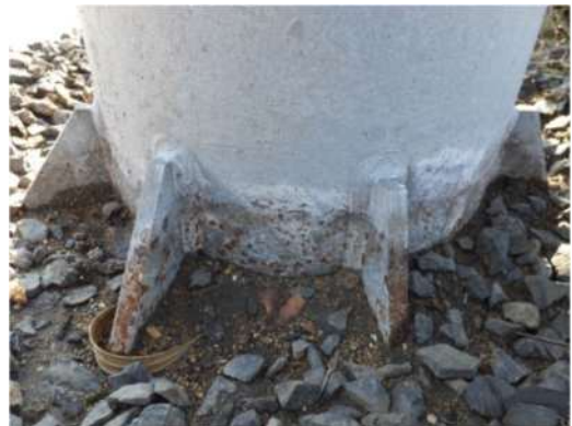
【支柱基礎：腐食、健全性Ⅲ】
