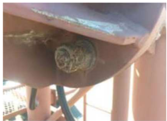
【横梁取付部：腐食、健全性Ⅱ】
