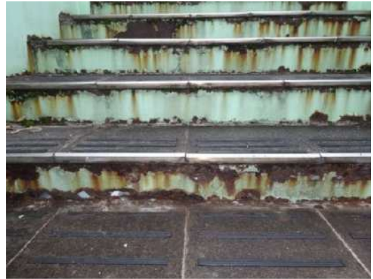
【階段部（蹴上）：腐食、健全性Ⅱ】
