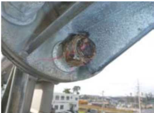
【横梁（標識板取付部）：腐食、健全性Ⅲ】
