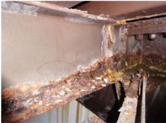
【横梁：腐食、健全性Ⅲ】
