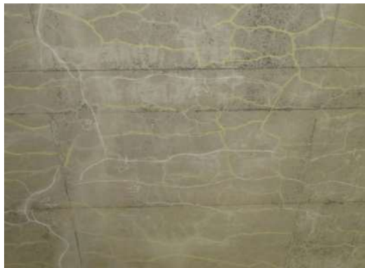
【本体工（頂版）：ひびわれ、健全性Ⅱ】
