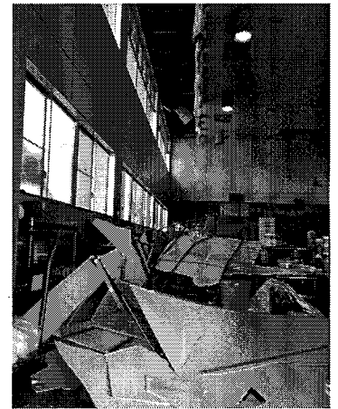
天井崩落など大きく損壊 (倉吉市給食センター)
