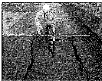
<下水道施設に起因する道路陥没>
