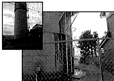
<配水塔の支持壁が破損 倒壊のお恐れ>
