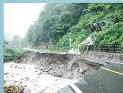
台風12号（平成23年9月）による道路の崩壊（倉吉江府溝口線）
