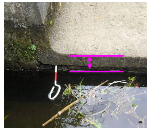
桁接合部の不良事例 接合部から漏水しているため水路の高さまで水が溜まっていない
