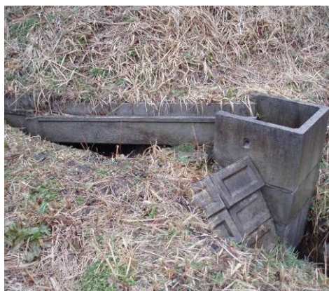
落差工の沈下事例 外側、底の土が流され陥没し、水路が沈下している。
