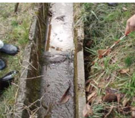
水路肩の陥没事例 目地からの漏水により土が流れ、陥没している
