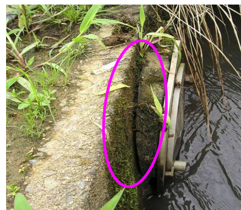
取水装置の不良事例 接合部に隙間ができている
