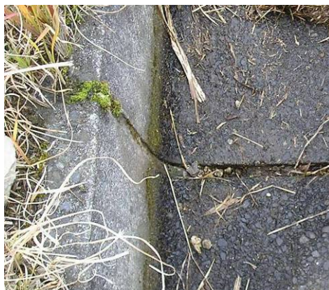
目地剥落事例 目地材がない
