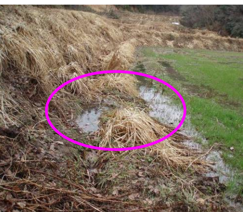
用水路の通水障害例 下流域への通水を障害し、圃場内に水が流入している
