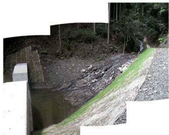
治山ダム施工により溪流内の堆積土砂の流出防止及び溪岸の浸食防止が図られ、周辺の森林が安定した。
