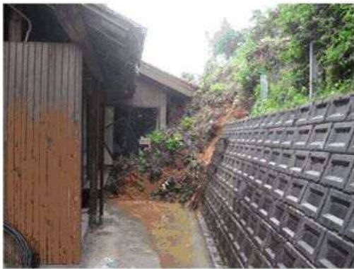
平成23年9月の台風豪雨により山腹斜面が崩壊し、不安定となった。崩壊により流出した土砂により下方の人家が損壊した。
