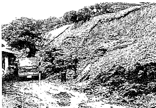
日南町神福地内被災状況
