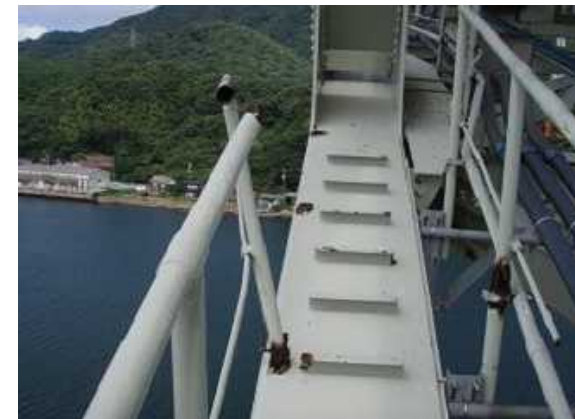
監査路の腐食・破断
