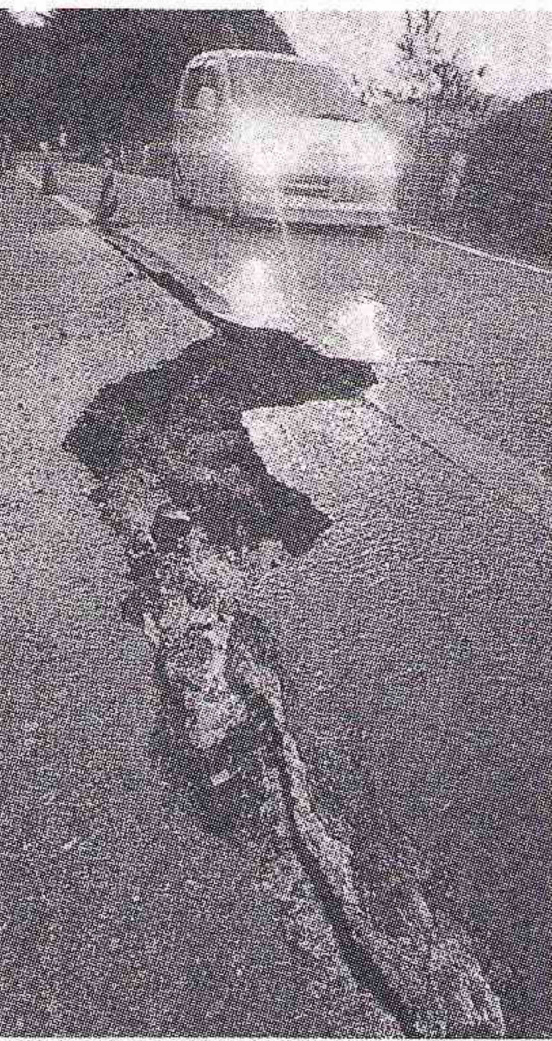
地震で陥没した国道180号—岡山県新見市千屋花見で6日午後6時、佐藤賢二郎写真
