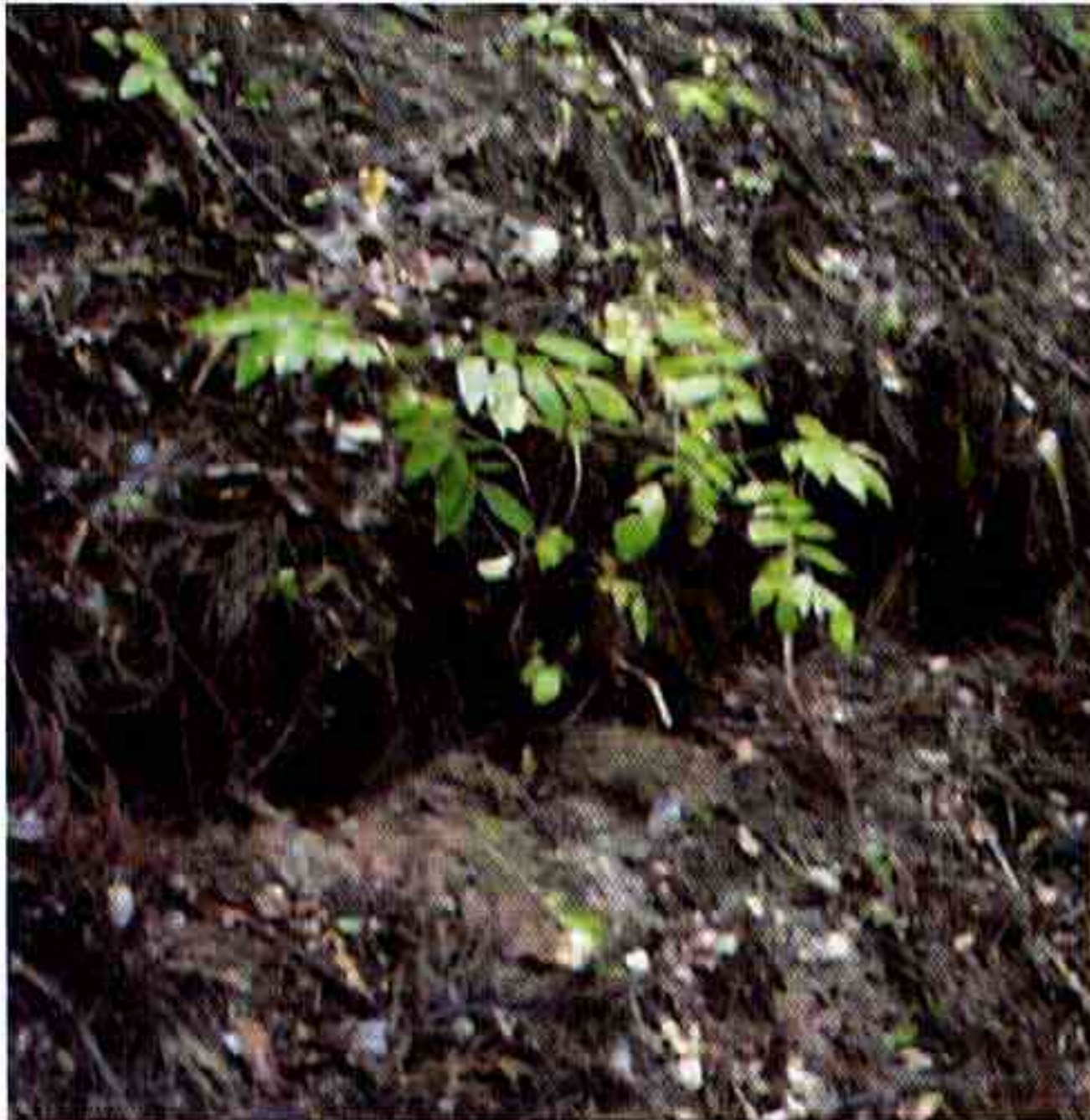
10月28日 伯備線106K770m亀裂
