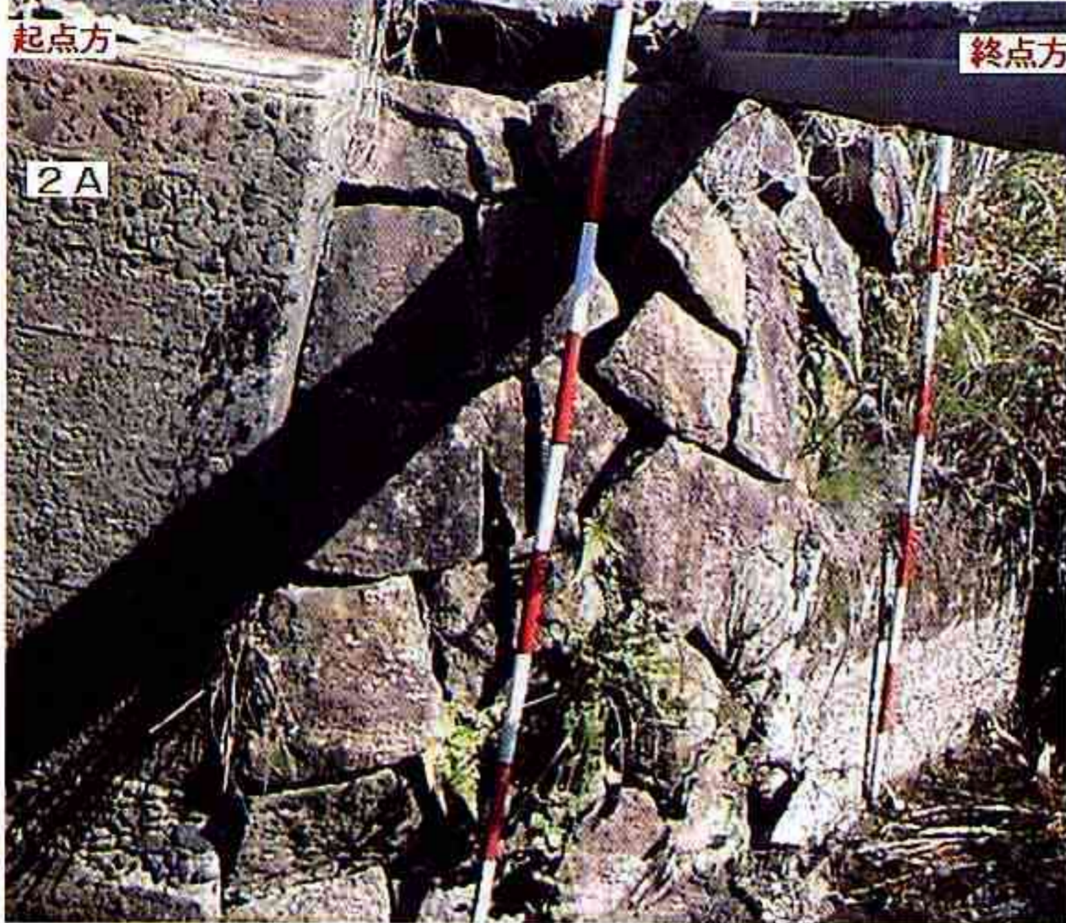
▼10月6日 伯備線108K001m護岸壁変状
