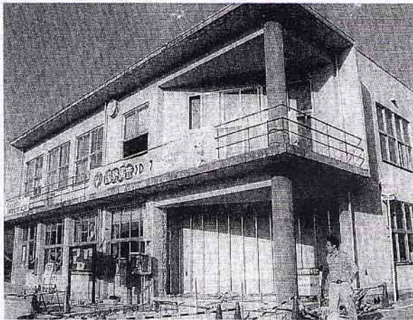
応急危険度判定で危険と判定された溝口町役場庁舎
