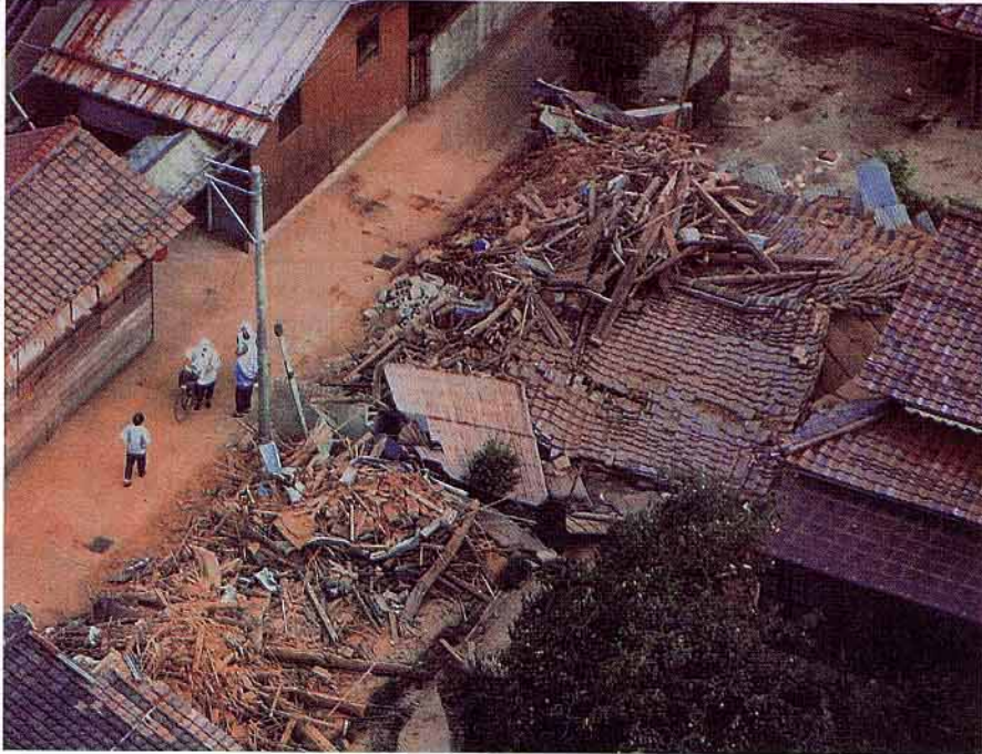
強い地震で倒壊した民家—6日午後5時20分、鳥取県境港市
