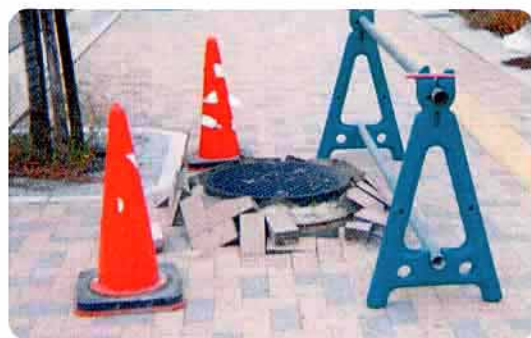
隆起したマンホール
