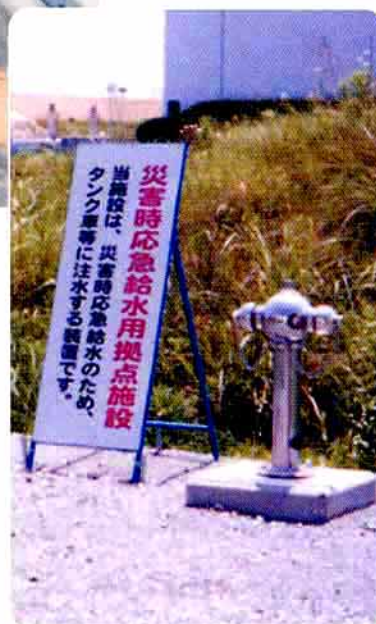
災害時に備え戸上水源地に4基設置した 応急注水施設
