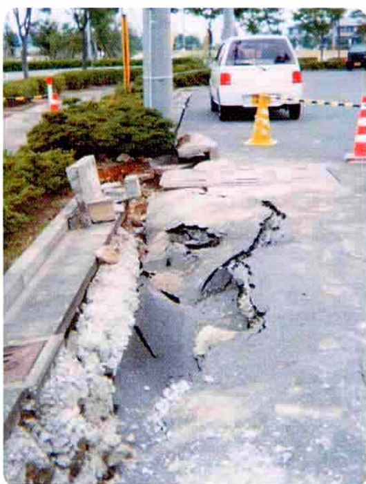
陥没した舗装道路
