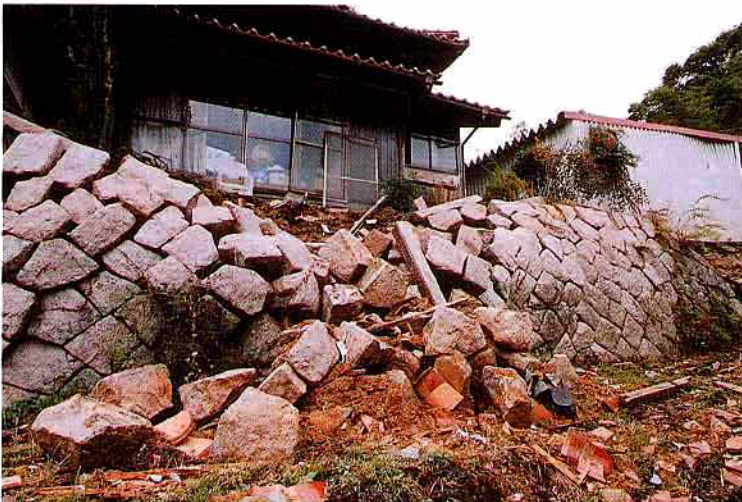
住宅の周りの石崖や擁壁が崩れる被害も発生（下黒坂地内）
