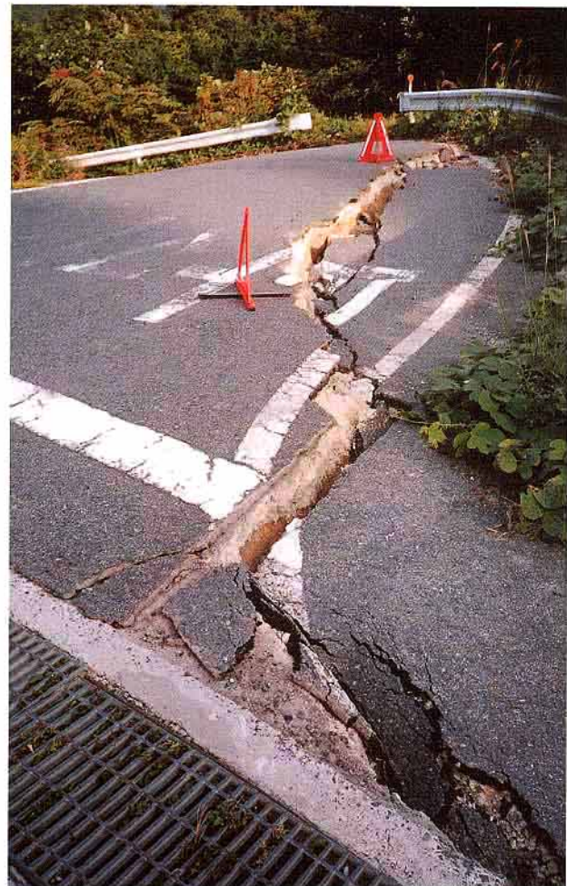
路面の亀裂や沈下が多く見られた町道（下黒坂地内）
