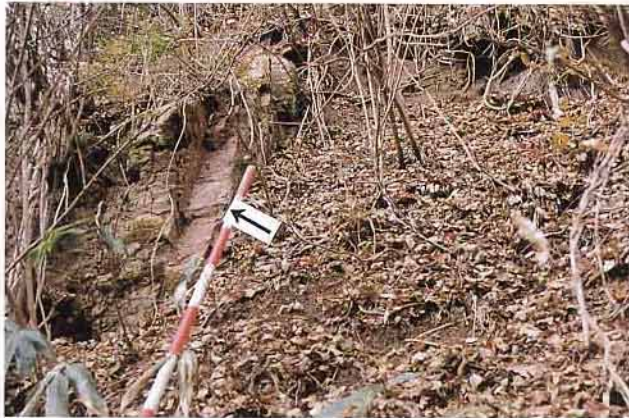
写真-2 差別浸食によって凸部をなす核岩(CL級岩盤)の縁辺部で発生したタイプAの落石。崩落した岩塊(矢印の位置にあった)はその一面(節理面)が自由面をなしていたと思われる。
