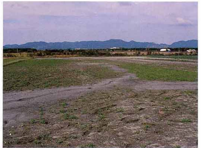
写真15 弓浜干拓，噴砂列の屈曲。この噴砂は地割れ群から噴出しており，地割れ群は約400m続き，埋立地を取り巻く堤防に平行するように屈曲する（山内他・第5図参照）。
