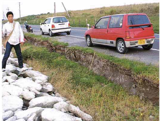
写真25 大海崎堤北側。護岸積み石の側方移動による陥没。
