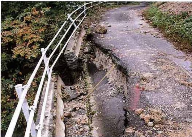
写真28 道路盛土部の沈下、日南湖周回道路、
