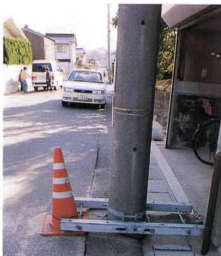
写真9 新十神団地。この電柱は約2m沈下した。電柱の沈下の進行をふせぐため電柱根元に金具が取り付けられている。多くの埋立地で電柱の沈下が確認された。
