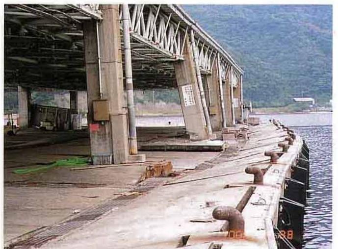
写真6 境港市昭和町、3号岸壁の被災状況。岸壁上の構造物が損壊しているだけでなく、岸壁上では噴砂が生じ、東側の岸壁が大きく張り出している。
