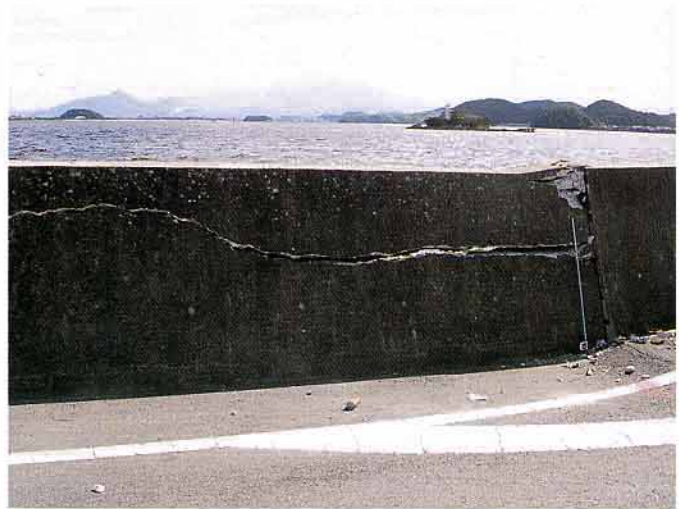
写真21 安来市亀島町。堤防の沈下による破損。
