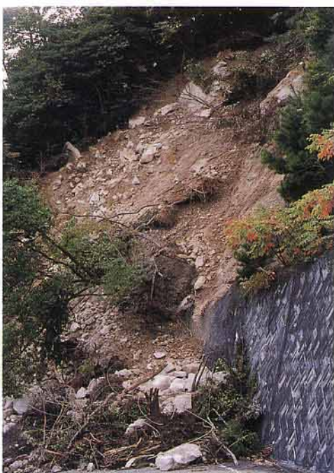
写真 36 角礫を含んだ花崗岩斜面の崩壊。日野町長楽寺。
