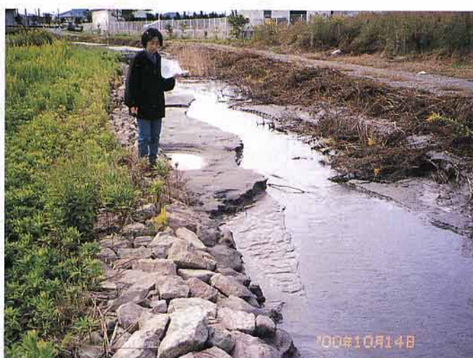
写真13 揖屋干拓。堤防沿いの水路に沿って噴砂が、道路には地割れが生じていた。弓浜干拓においても、堤防沿いの水路や道路は多くの個所で破損されている。
