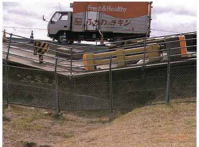
写真4 中浦水門西側取り付け部。道路の下が大きく抜けて道路が陥没している。
