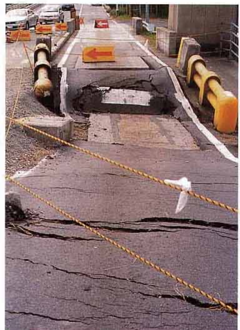
写真31 中浦水門周辺の沈下、
