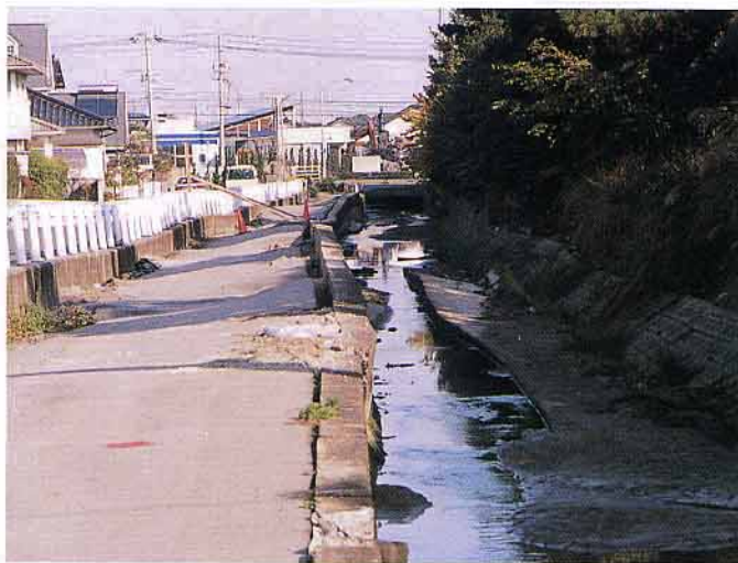
写真8 安倍彦名団地。水路底の隆起と擁壁の押し出し(左側)とすべり(右側)。水路わきの道路に沿って噴砂が生じ、道路は円弧すべりのように沈下した。
