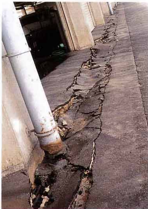
写真30 米子魚市場の変状、
