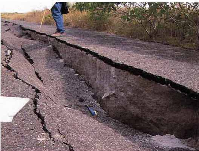
写真18 大海崎堤南側の裾部にみられる地割れに伴う陥没。
