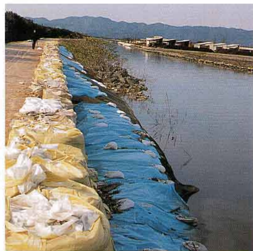
写真23 弓浜干拓。南東部の堤防護岸の積み石のすべりと堤防沈下。青いシートをかぶせてある部分では護岸積み石が水没してみえない。
