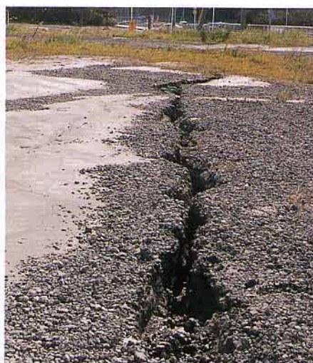
写真10 竹内工業団地。地震直後はほとんど開いていなかった地割れの1ヵ月後のようす。
