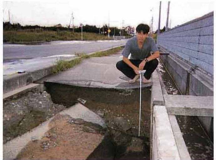
写真2 竹内工業団地。液状化・流動化に伴う歩道の陥没。陥没量は約1m。
