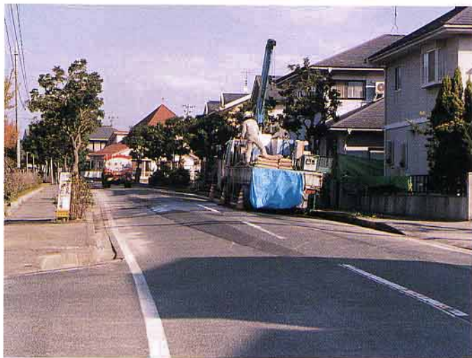
写真7 安倍彦名団地。不同沈下によって道路は激しく波打っている。この団地では不同沈下によって多数の家屋が傾いた。
