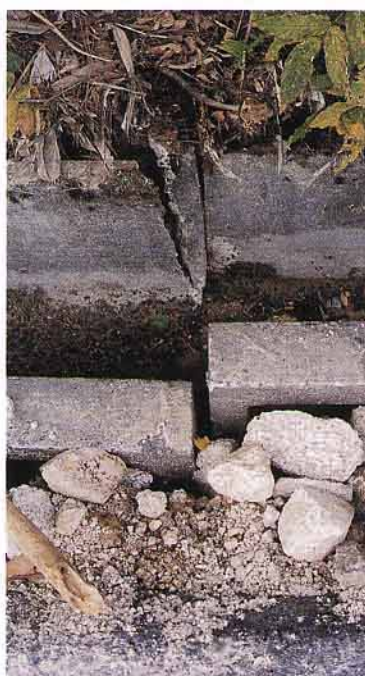
写真 37 斜面の大規模な土砂移動に伴って生じた側溝を横断するクラック。左横ずれに変位している。日野町長楽寺。
