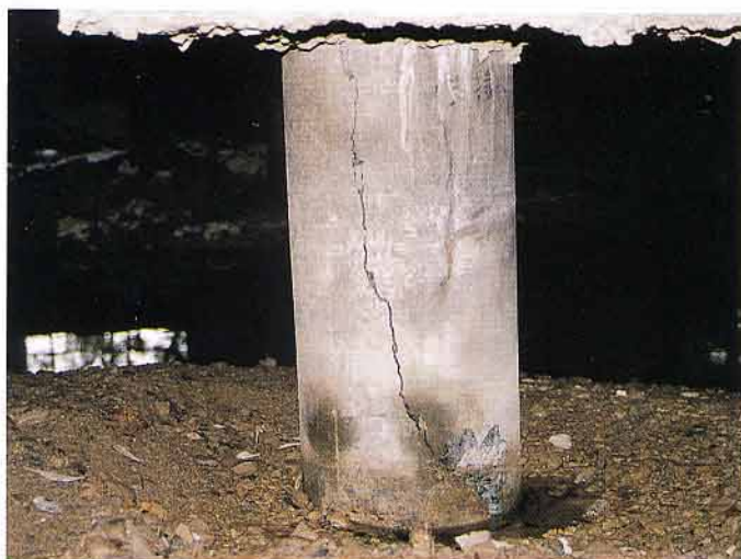
写真12 彦名干拓水鳥公園。地盤沈下で露出した観察館の基礎杭。杭には割れ目が生じている。
