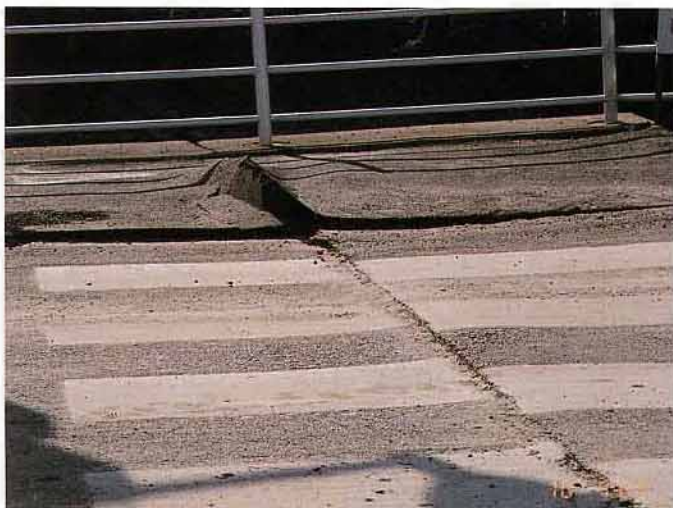
写真5 竹内工業団地。液状化流動化によって横ずれ変位を示す横断歩道。この割れ目の走向は東西性で、最大変位量は26cmある。本団地内では東西性の水平圧縮による変形が数ヶ所で認められた。
