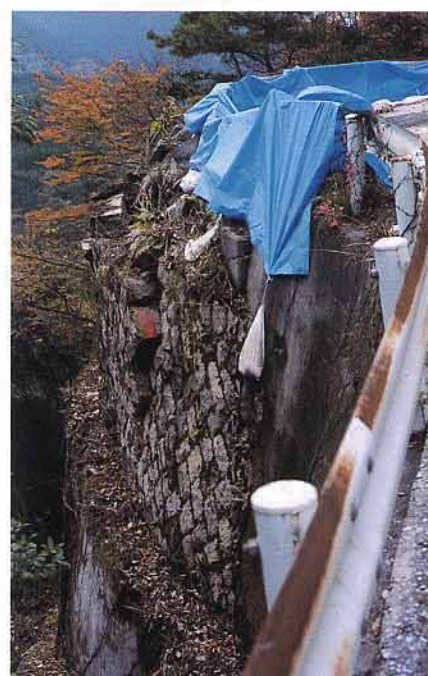
写真 38 道路擁壁の水平移動。日野町長楽寺。
