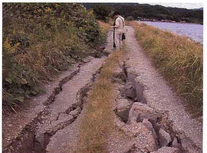
写真19 西部承水路堤東側の裾部の地割れ群。この地割れ群は1500m以上続いている。
