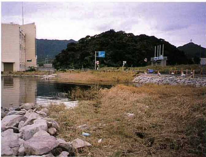
写真22 森山堤南側。約80mにわたって護岸がすべって道路が沈下。
