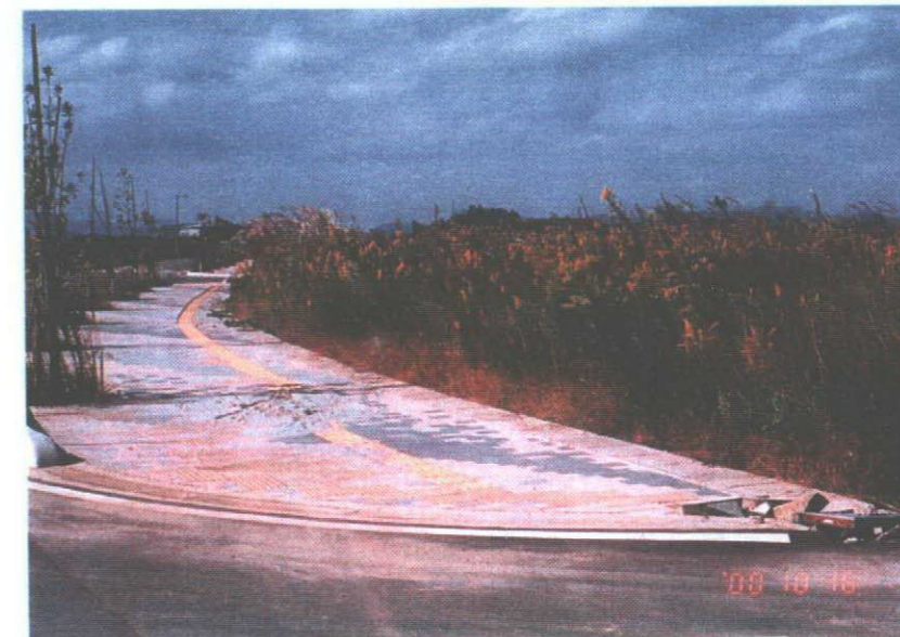
写真-12：歩道部のインターブロックと点字ブロック境界からの噴砂。
