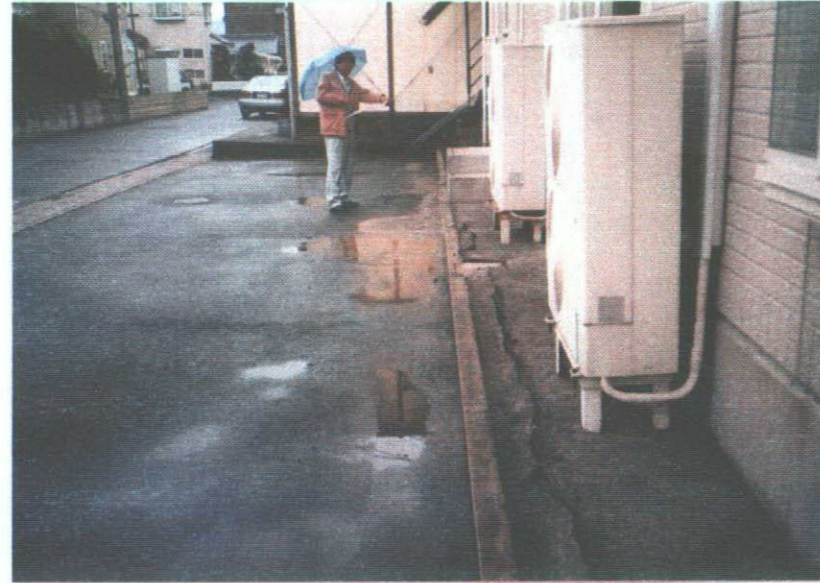
写真-14：アスファルトの圧縮亀裂。
