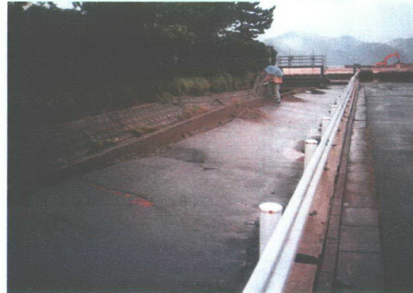
写真-2：同上。水路側壁の持ち上がり、前傾。ガードレールわきのL型とアスファルト境界に噴砂跡。
