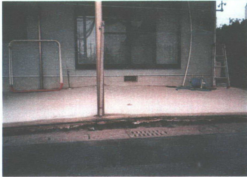
写真-13：コンクリートたたきの浮き上がり。(路面の沈下?) 開口部より噴砂。
