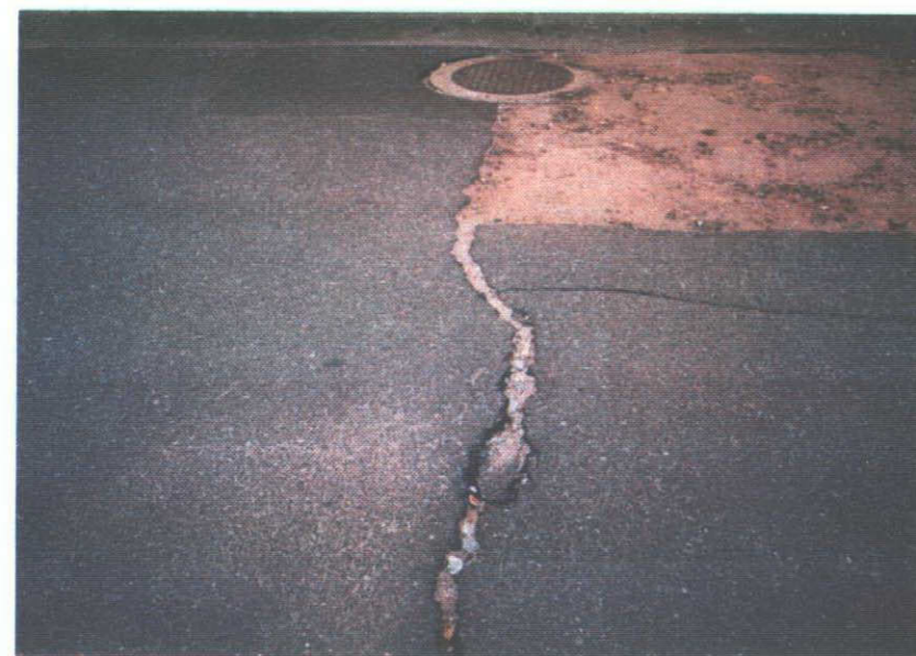
写真-4：路面に生じたクラック（クラック沿いに噴砂跡）水路から30～40m離れて同様の亀裂が見られる。
