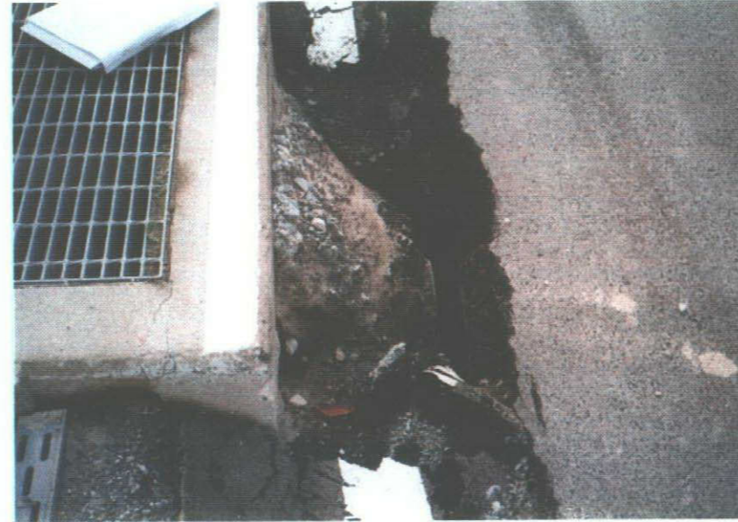
写真-2：道路の沈下と樹の周辺地盤陥没。ヒューム管の 接続部が離れ、段差が生じている。
