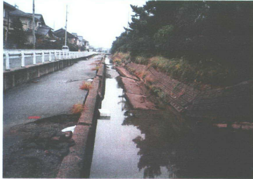
写真-1：水路側壁の倒壊、ブロックのずれ落ち（下水処理場側）住宅側の側壁は持ち上がり、前傾。水路床の持ち上がり。
