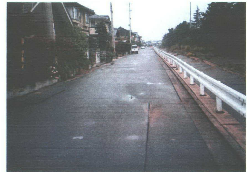
写真-9：水路沿いの道路のうねり。
