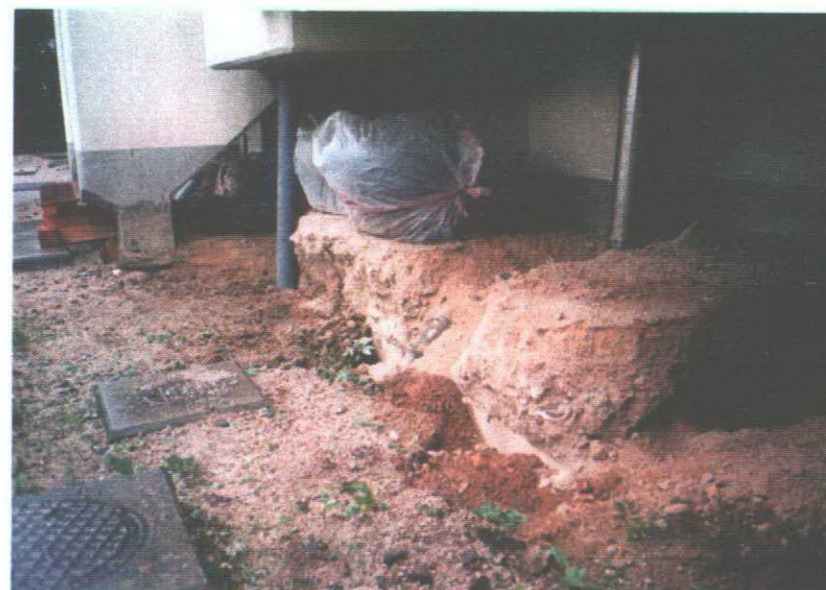
写真-11：県営、市営住宅の各所で見られる抜け上がり。
