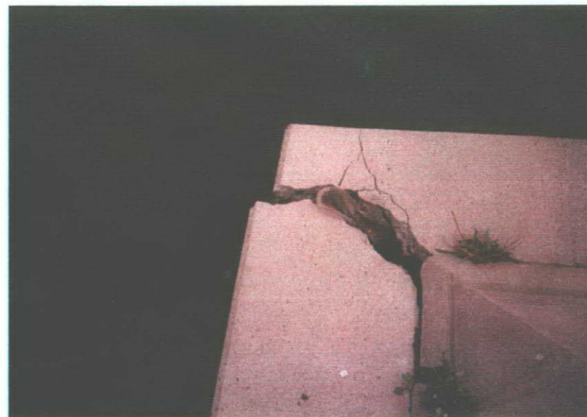
写真-8：護岸コーナー部の頭部コンクリートの破断、ずれ(5cm)
