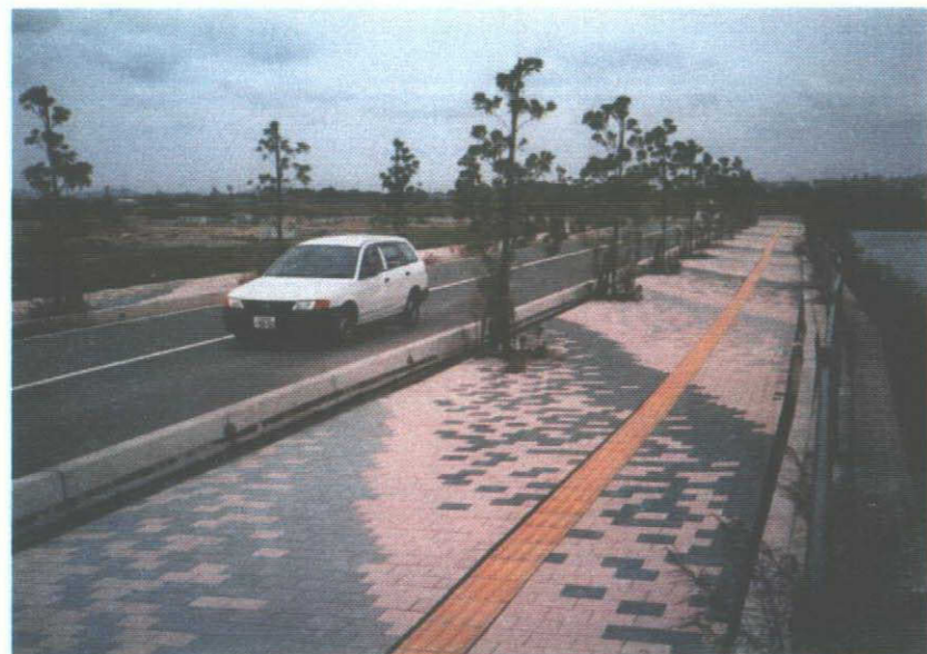
写真-7：護岸のはらみだし、インターブロックの沈下。 (歩車道～インター～転落防止策の継ぎ目の開き)
