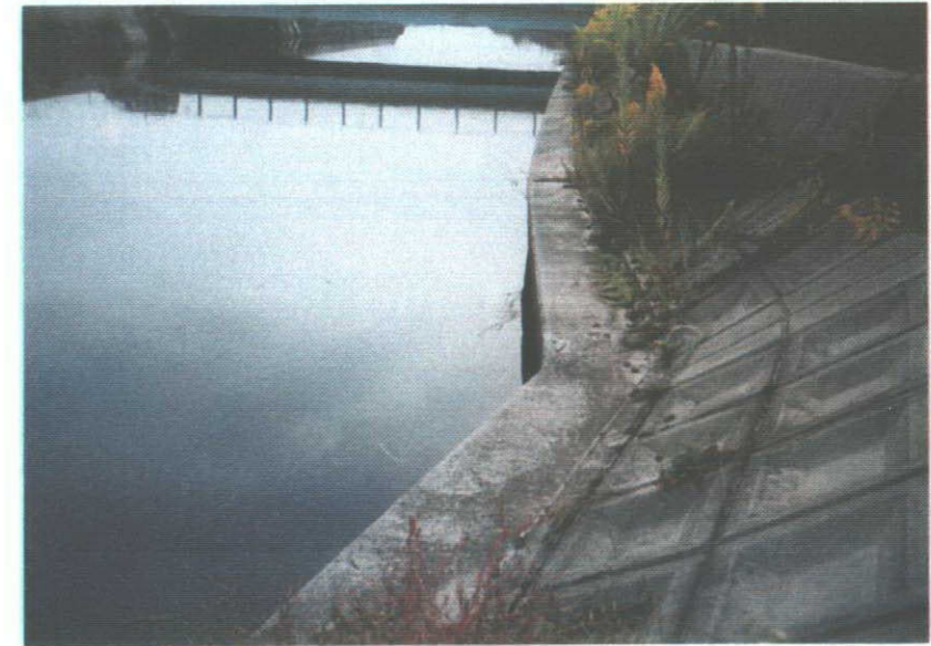
写真-3：護岸のはらみだし
