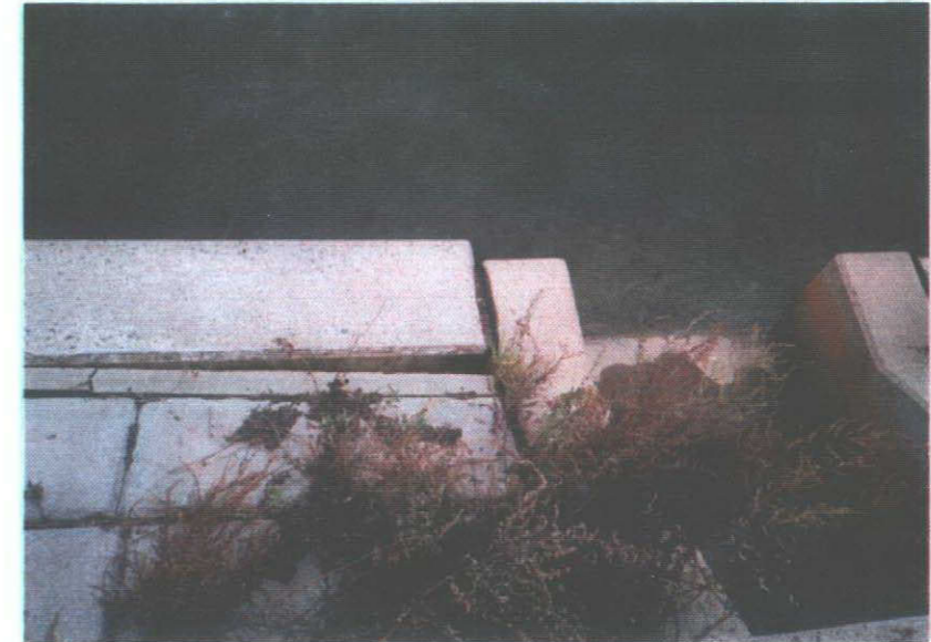
写真-6：矢板護岸頭部コンクリートの押し出し変形(頭 部は前面に傾斜)
