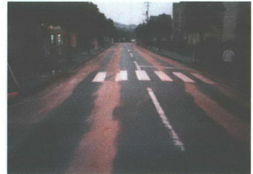
写真-3：地下の水路ボックス浮き上がりにより道路面に生じたクラック（まさ土を詰めてある。）路面は歩道部より高くなっている。
