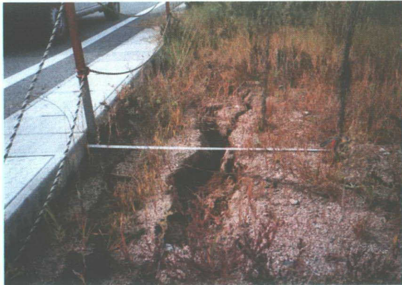
写真-1：側溝背面地盤のクラックと沈下(10cm) (道路面も 5cm 程度沈下)
