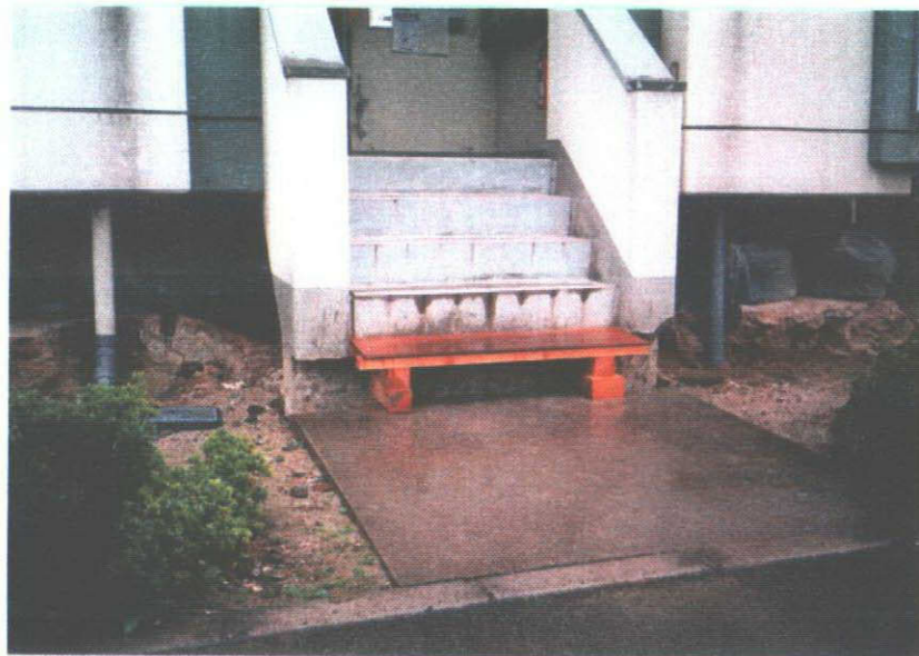
写真-10：基礎の抜け上がり(30cm)に伴う階段の継ぎ足し。(県営、市営住宅の各所で見られる。)排水管は破損(修理済み)
