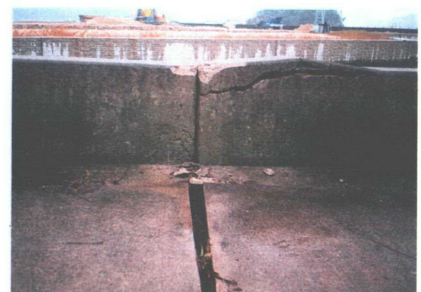
写真-6：パラペットの破損。ジョイント部の開口。
