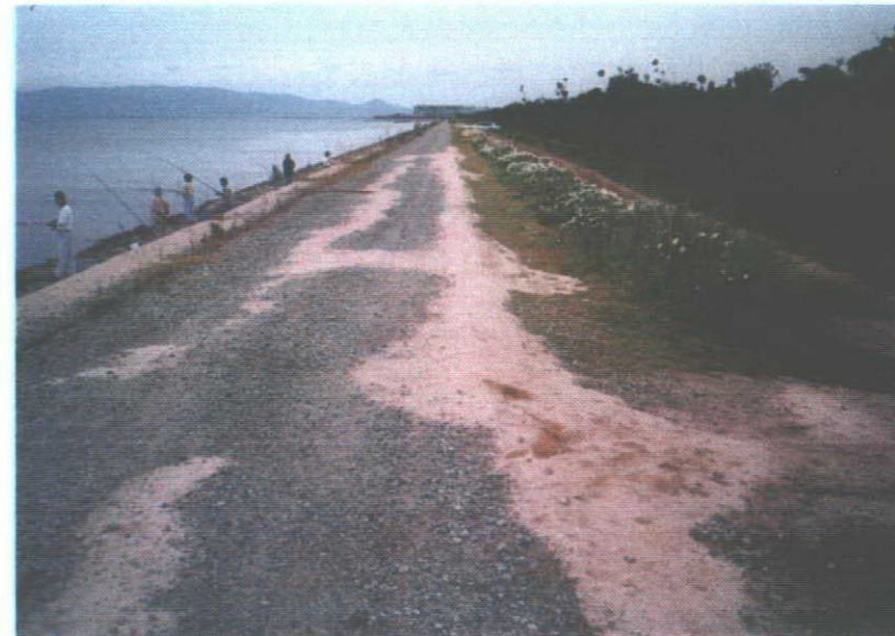
写真-5：堤防天端に発生した縦断クラック(幅3~5cm) (クラックにはまさ土が撒かれている)
