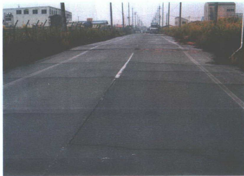
写真-5 道路に直行する多数のクラック
