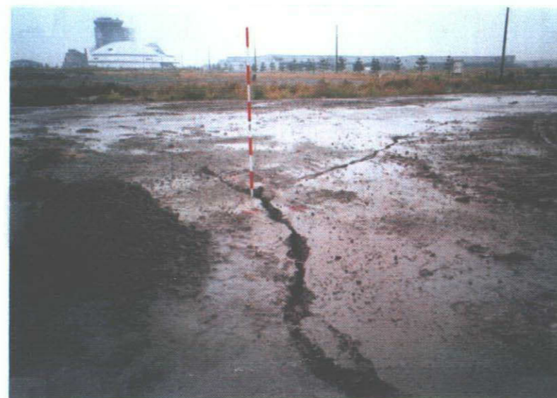
写真-11 開口クラックに見られる噴砂
