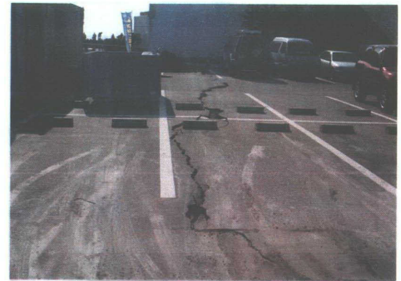
写真-6 駐車場に見られるクラック
