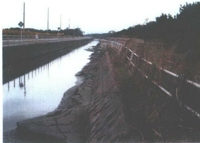
写真-23 水路の両側の護岸とも水路中心に押されていつ。川底は隆起しその上は填砂の砂が堆積している。
