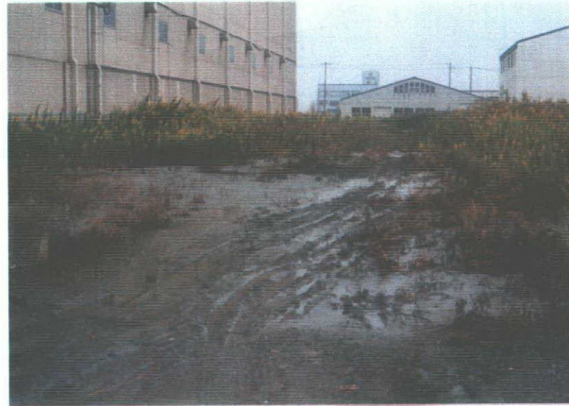
写真-20 填砂により一面に砂が流出
