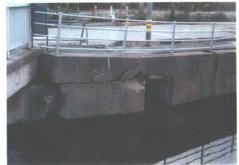
写真-24 橋台部の変状 水路の護岸が押し出されている
