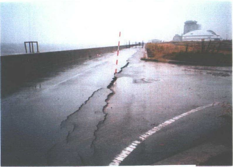
写真-4 護岸と平行したクラック
