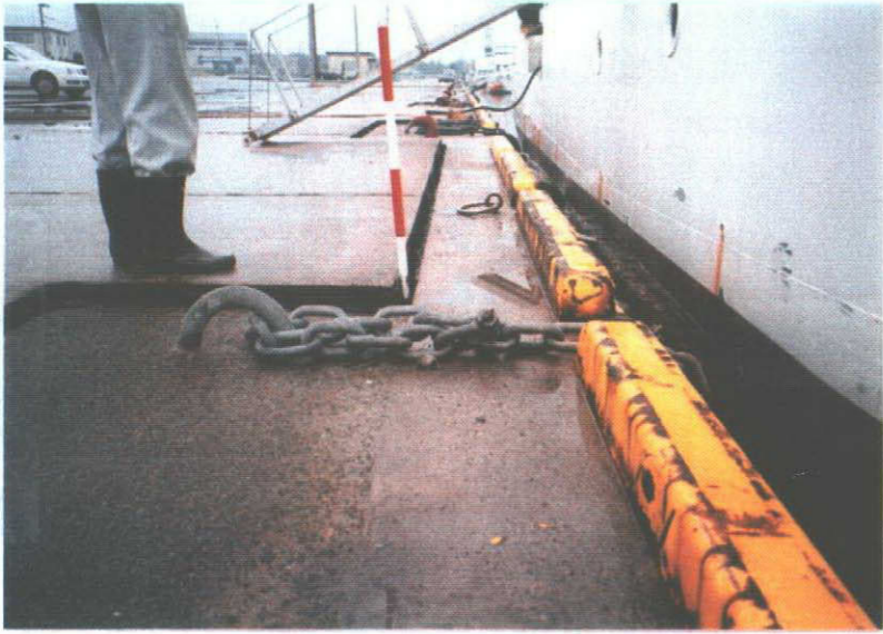
写真-1 護岸の沈下
