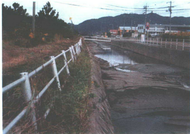
写真-22 水路の両側の護岸とも水路中心に押されていつ。川底は隆起しその上は填砂の砂が堆積している。
