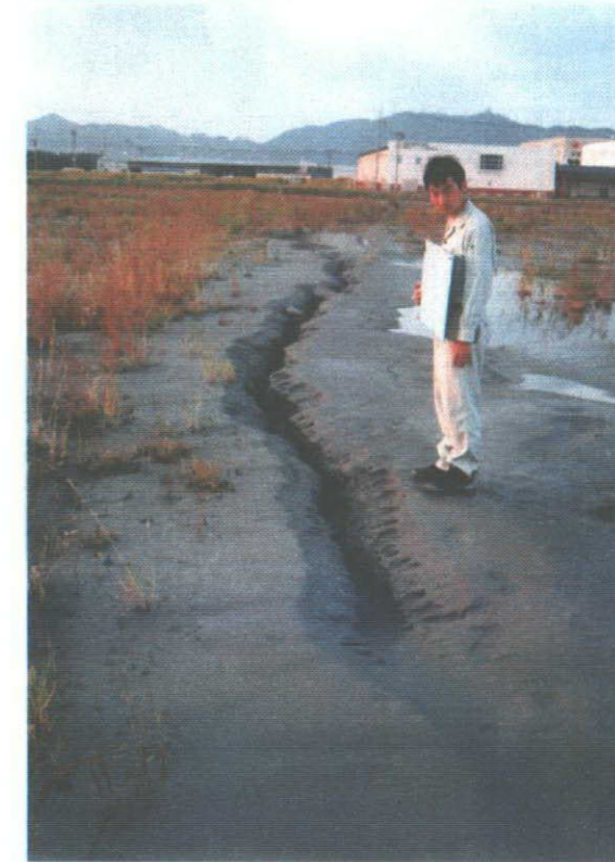
写真-9 開口クラックに見られる噴砂
