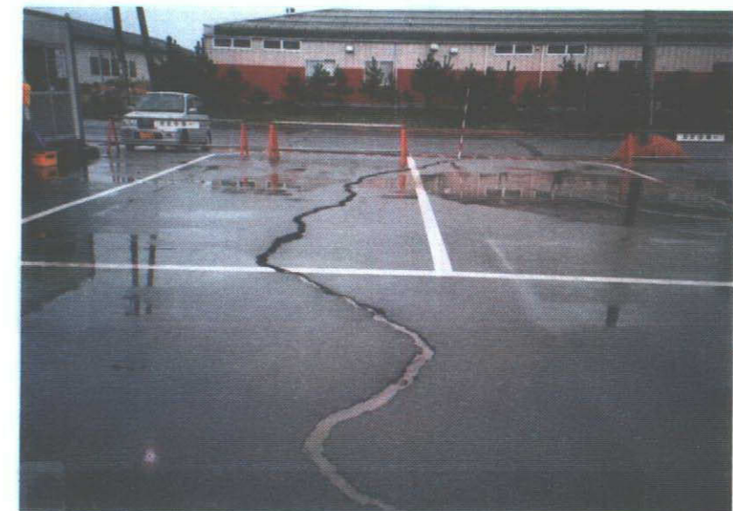
写真-12 開口クラック。噴砂は片づけて残って無いが噴砂が亀裂内に分
