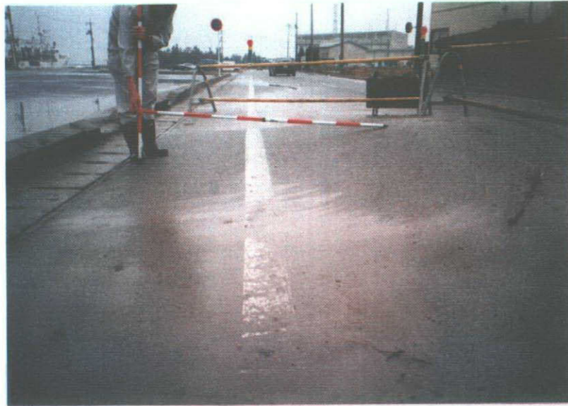
写真-19 路面の浮き上がり
