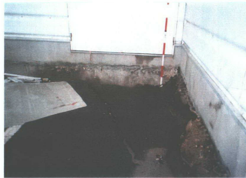
写真-14 建物の抜け上がり状況
