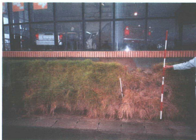
写真-16 盛土法面がずり落ち基礎が むき出しになっている
