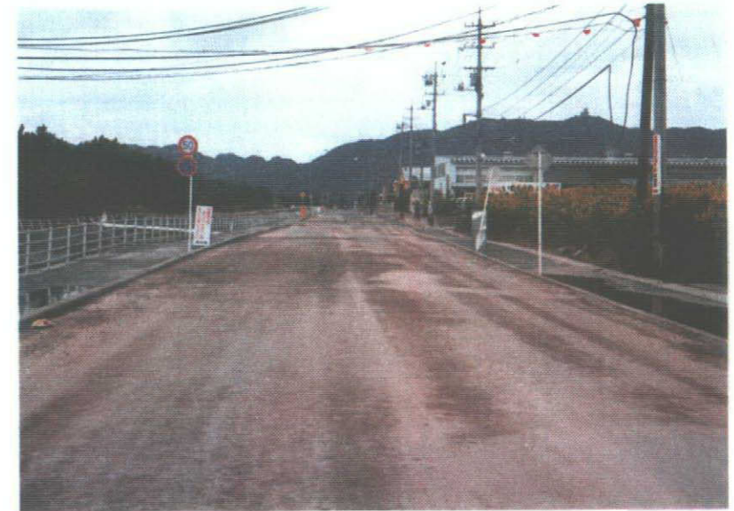
写真-21 被災を受け仮復旧している
