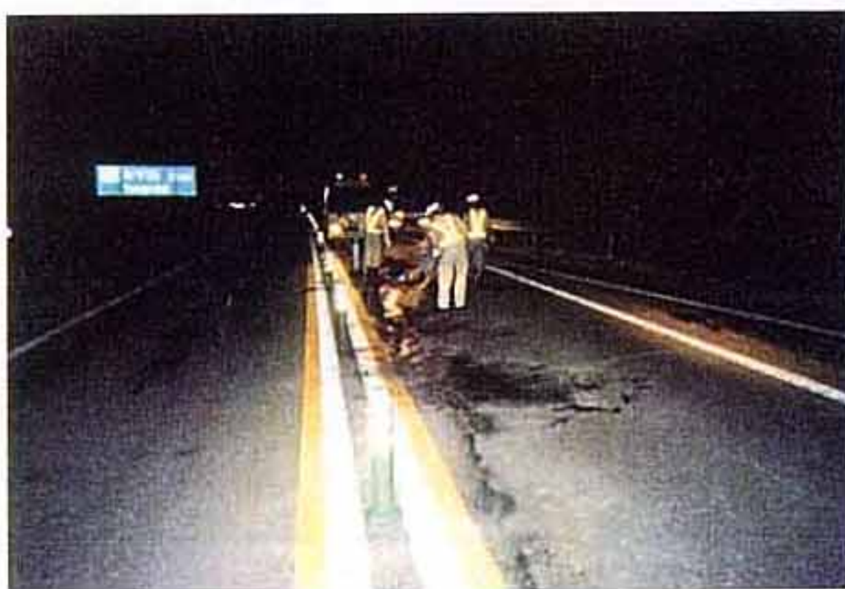
クラック補修
