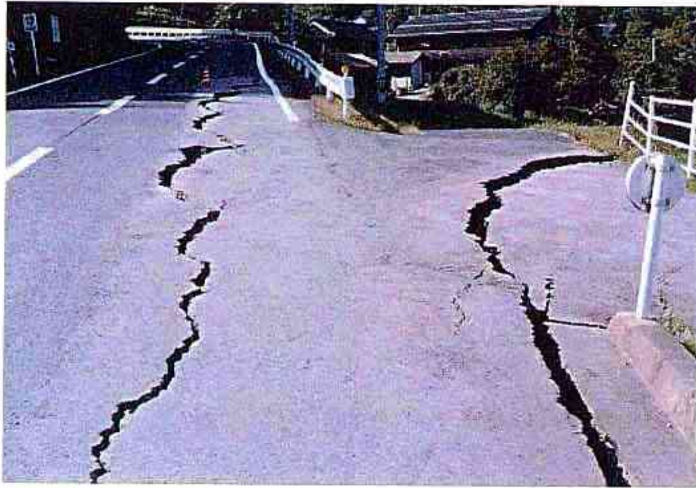
⑯路面の亀裂（溝口町） 14)
