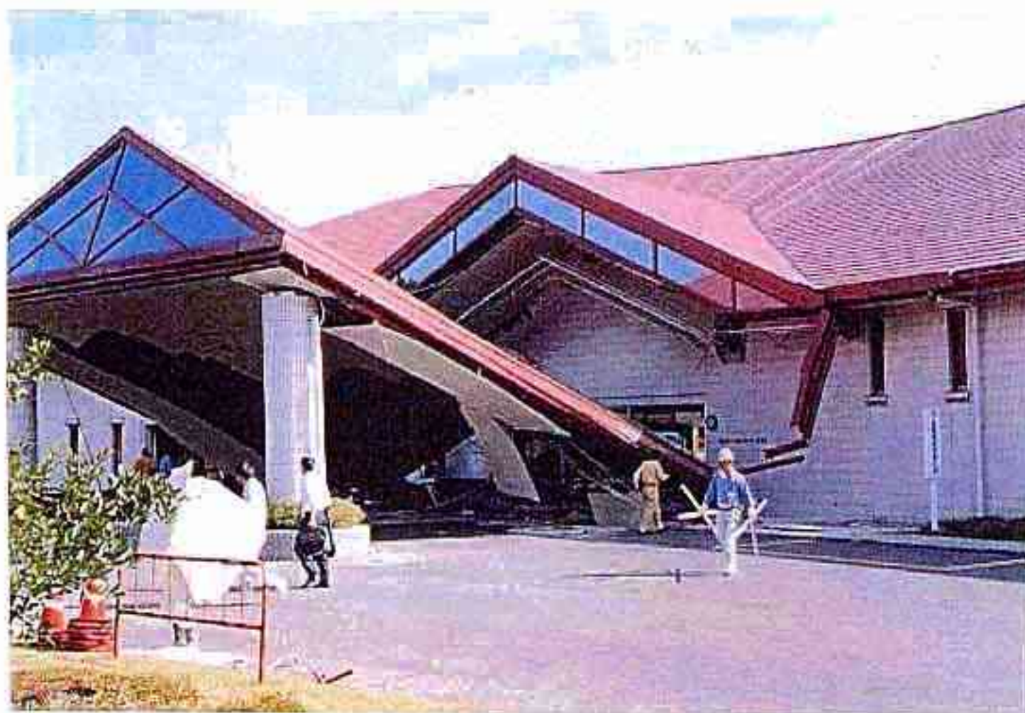
⑱ゴルフ場クラブハウスの被害（江府町） 14)
