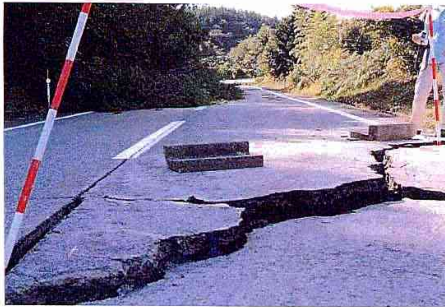
⑰道路の被害（溝口町） 14)
