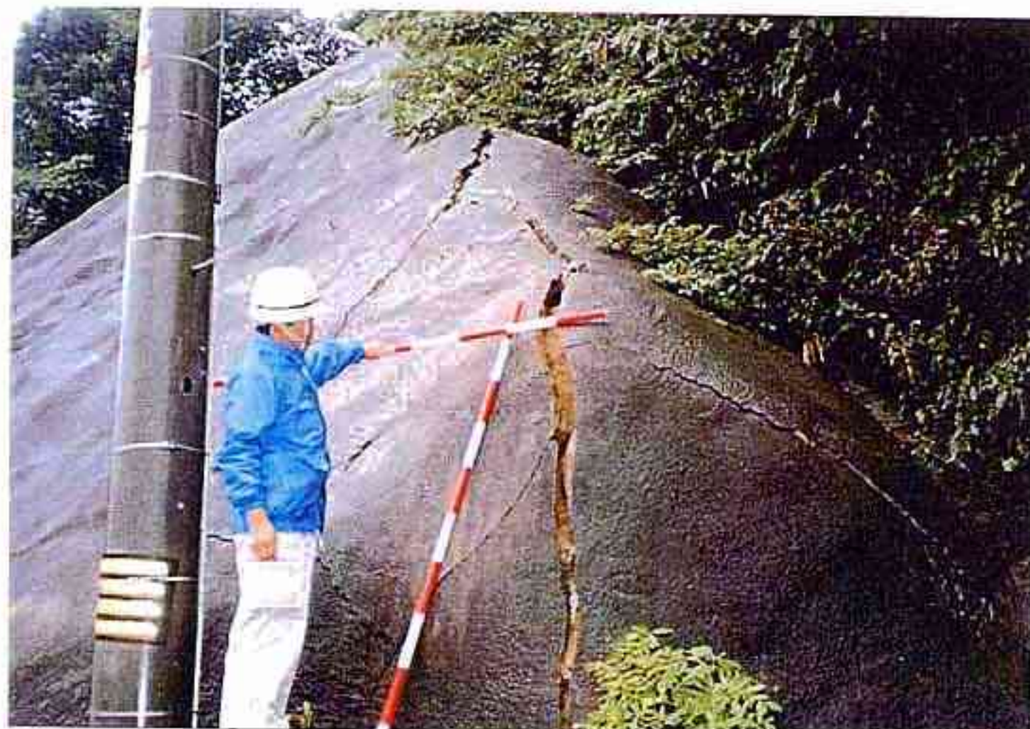
⑥モルタル吹きつけのり面の亀裂（国道180号 西伯町） 9)
