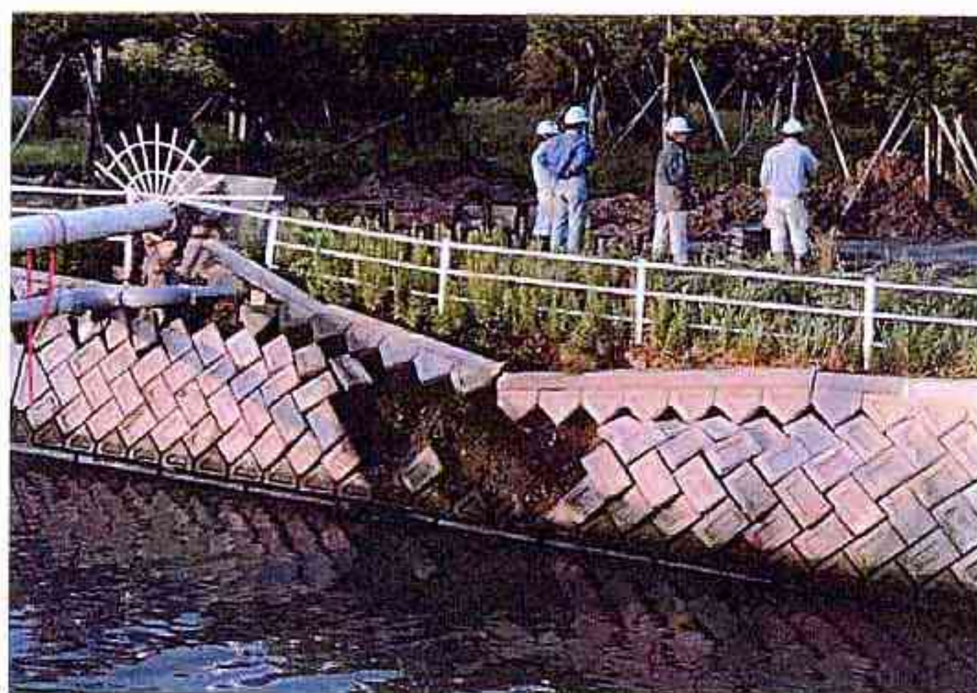
⑫護岸の崩壊（竹内工業団地） 7)
