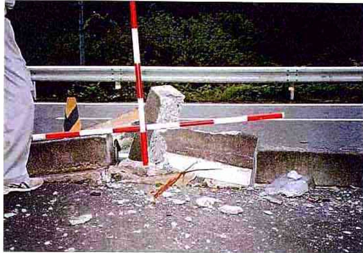
⑧縁石の破壊と路面の亀裂（国道180号 西伯町） 9)
