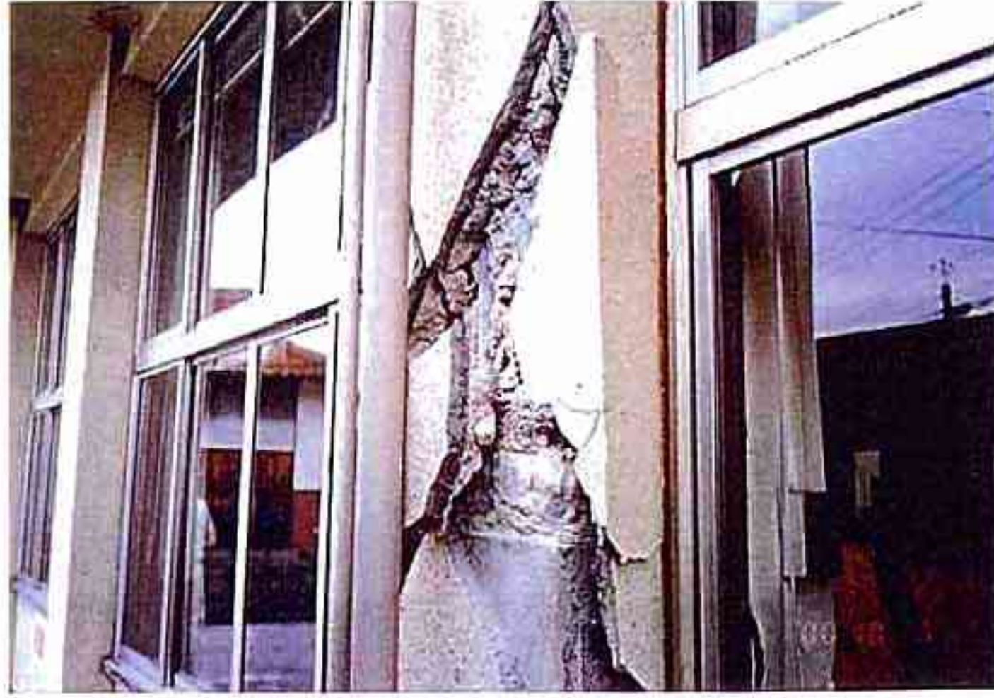
⑬建物外壁の亀裂（溝口町役場） 1)
