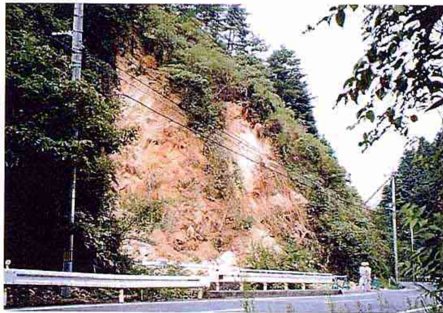
⑤斜面崩壊（国道180号 西伯町） 9)
