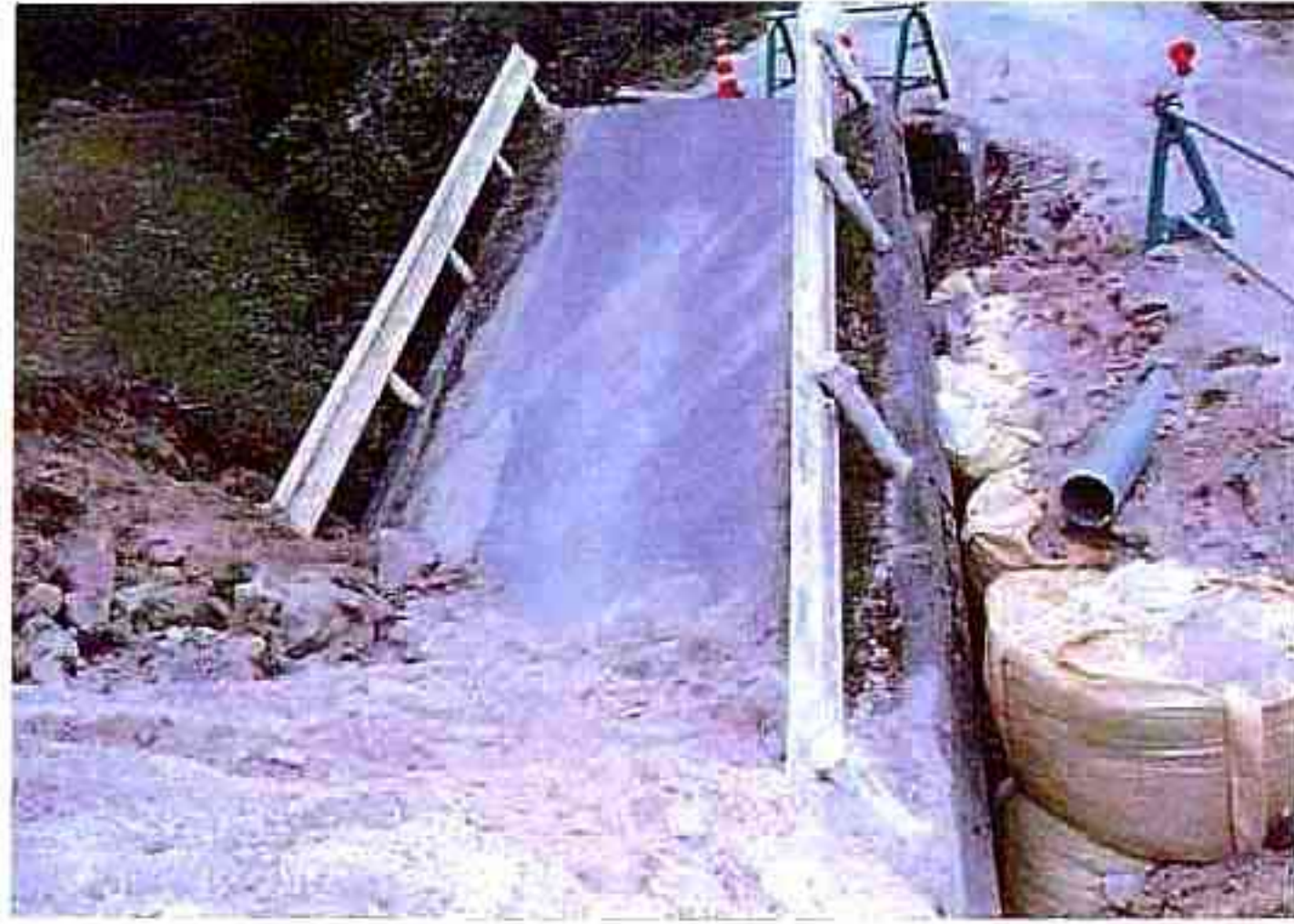
①赤谷橋の落橋（西伯町） 7)
