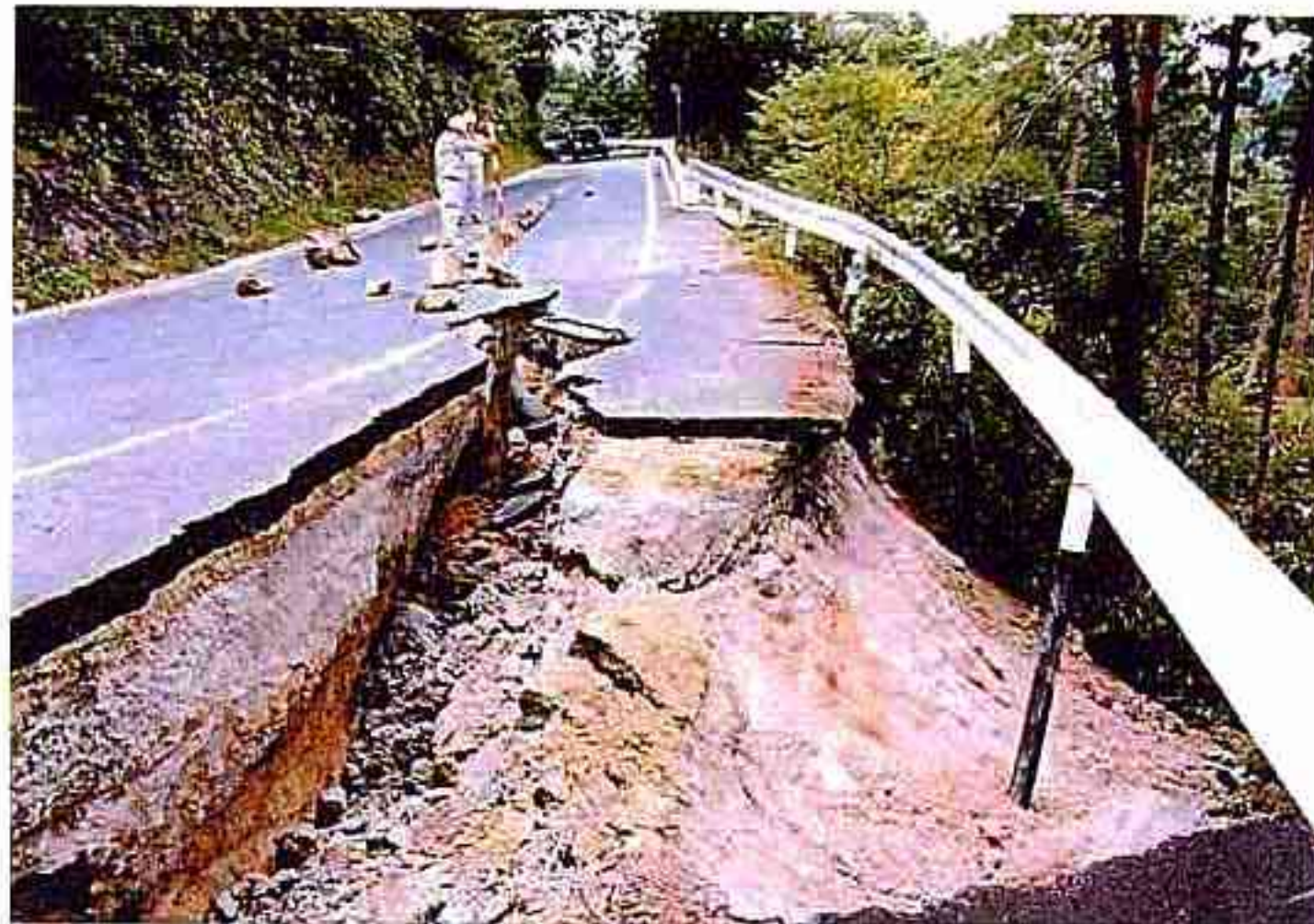
⑨盛土のり面の崩壊（江府町） 9)
