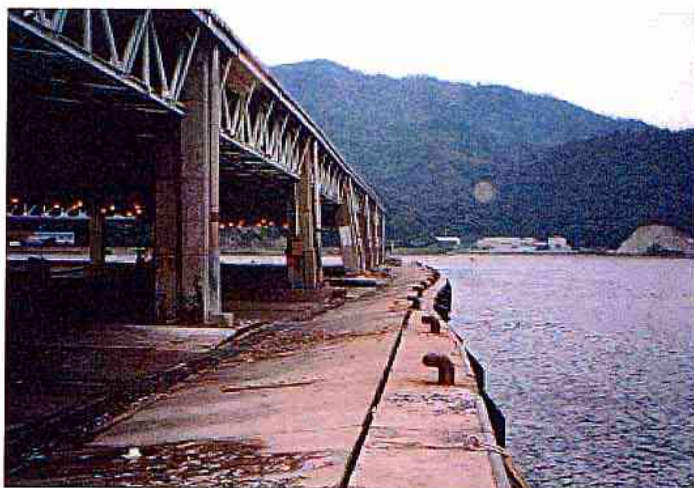
⑩岸壁のはらみ出し（境港漁港） 6)
