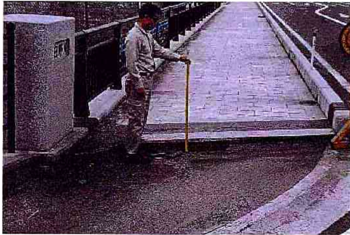
②橋台裏込め土の沈下（日野町） 11)
