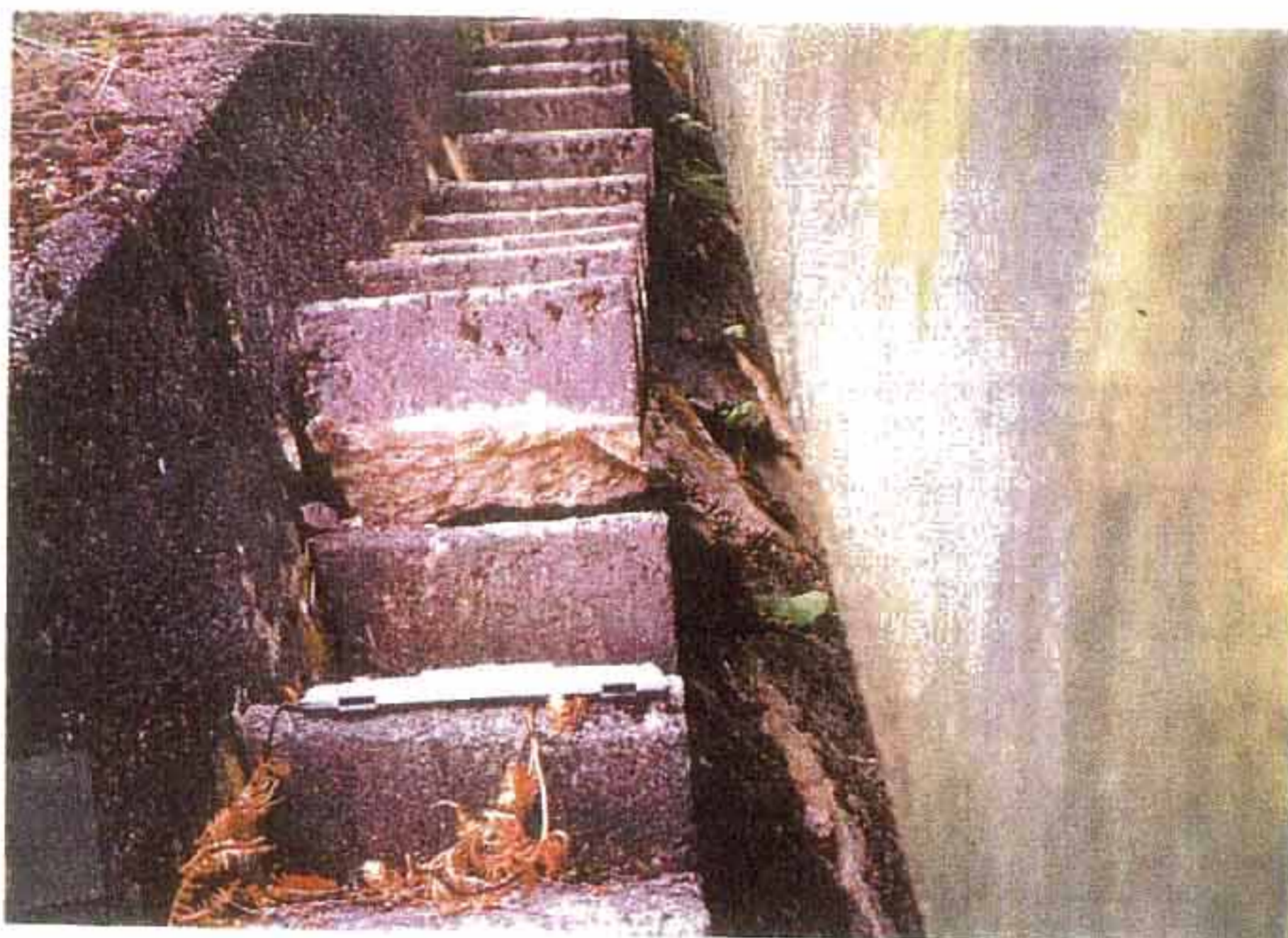
右側階段，インパクト 張コンクリートのクラック
