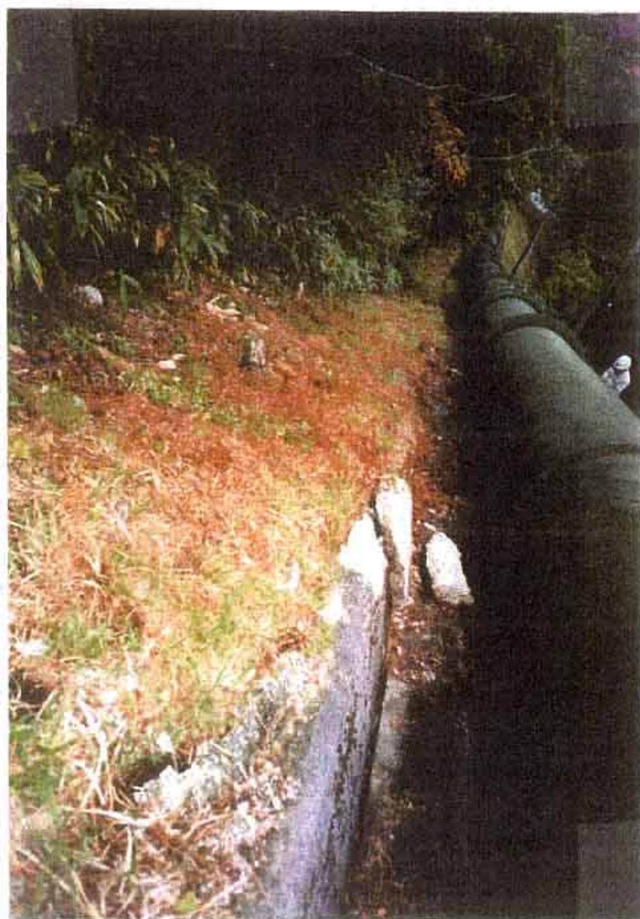
左側擁壁，クラック
