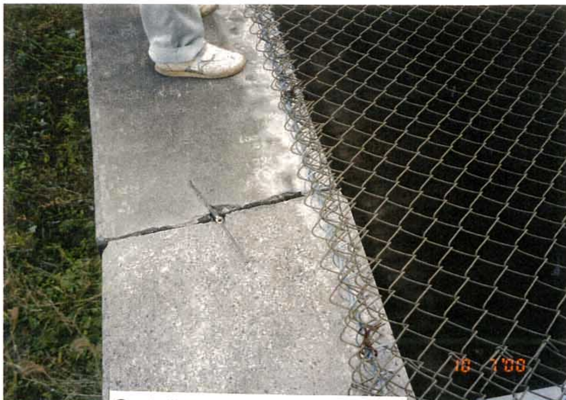
③ 3号蓋渠 (Boxカバー) 目地の開き 及びズレ
