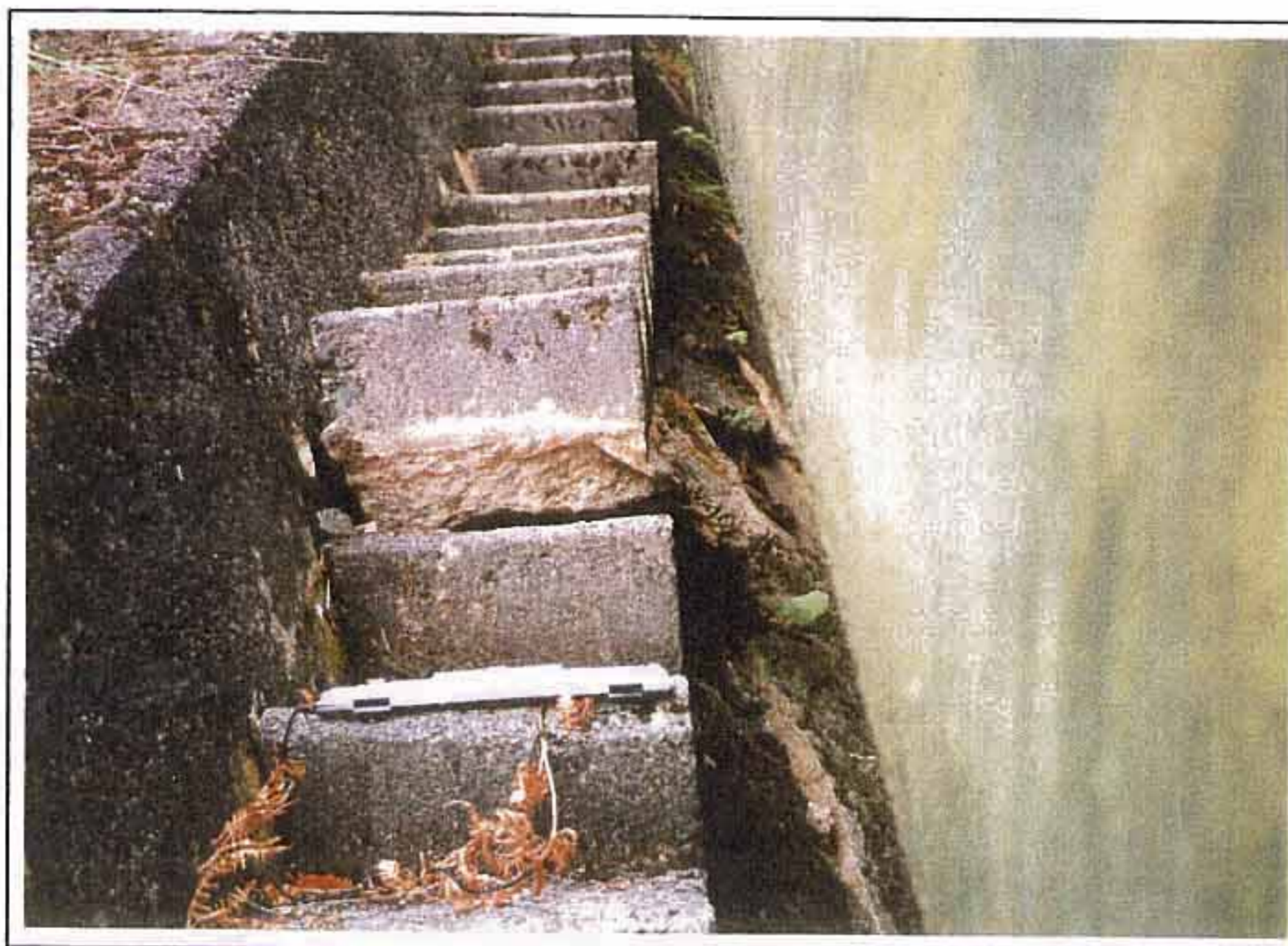
写真-3 1ステップ分、下方へ乗り上げた巡視路階段。鉄管路下の張コンにもクラックが発生しているが、階段横擁壁の同一位置には顕著な変状は見られない。
