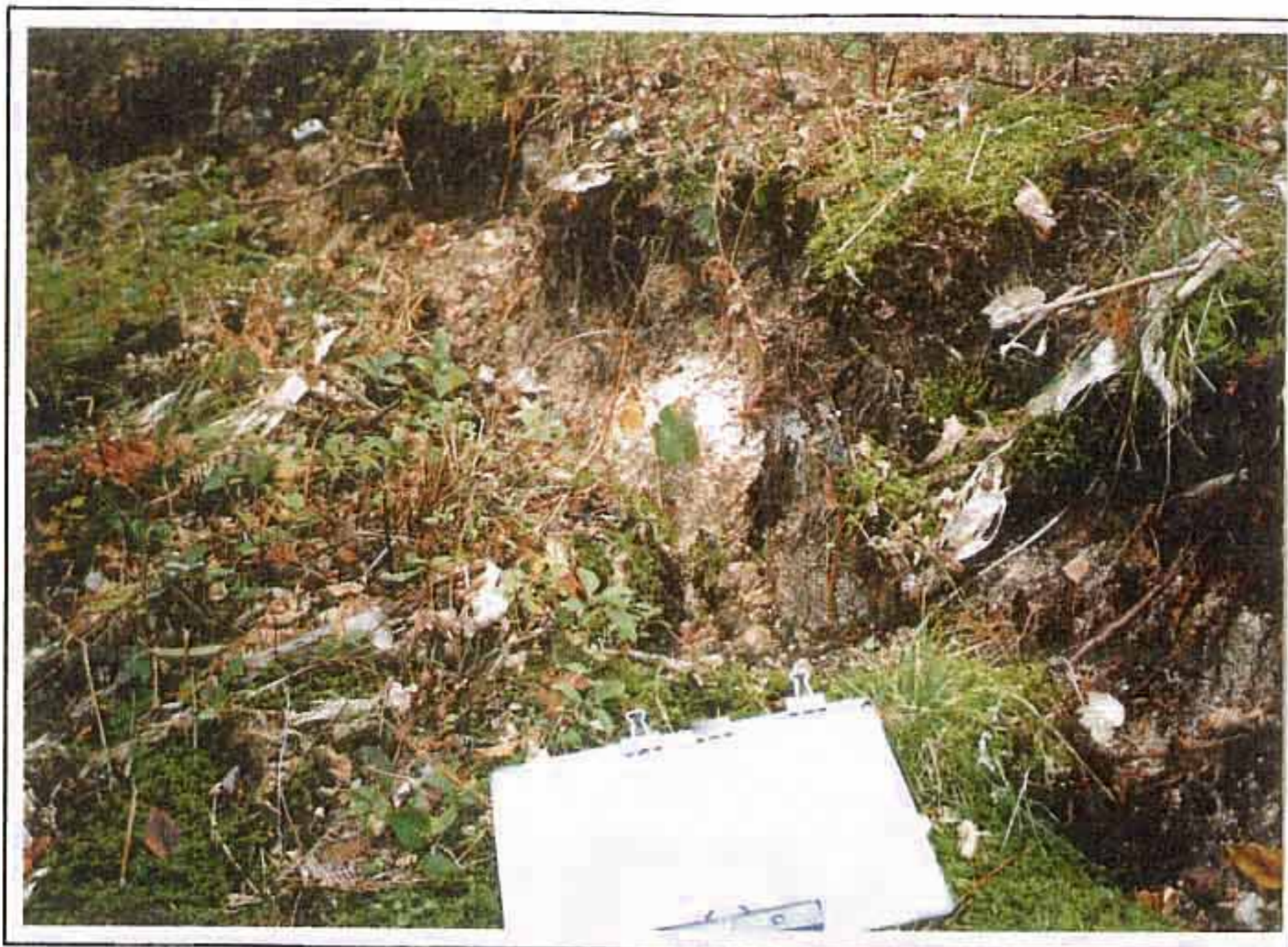
写真-2 388m盤に発生したクラックの近景。 最大開口幅は約 40cm で、段差は約 30cm
