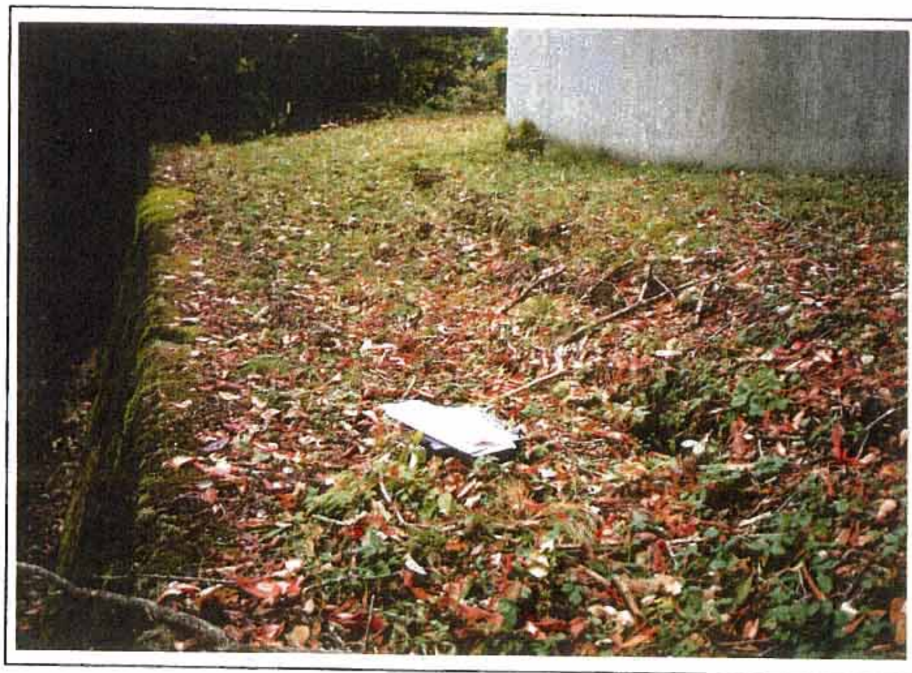
写真-1 クラックの遠景。 切盛境付近に延長約 10m と 6～7m の 2 本のクラックが認められる。写真は 10m のクラック。
