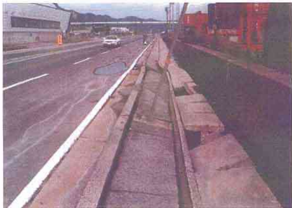
県道境外港線南側側溝の変状
