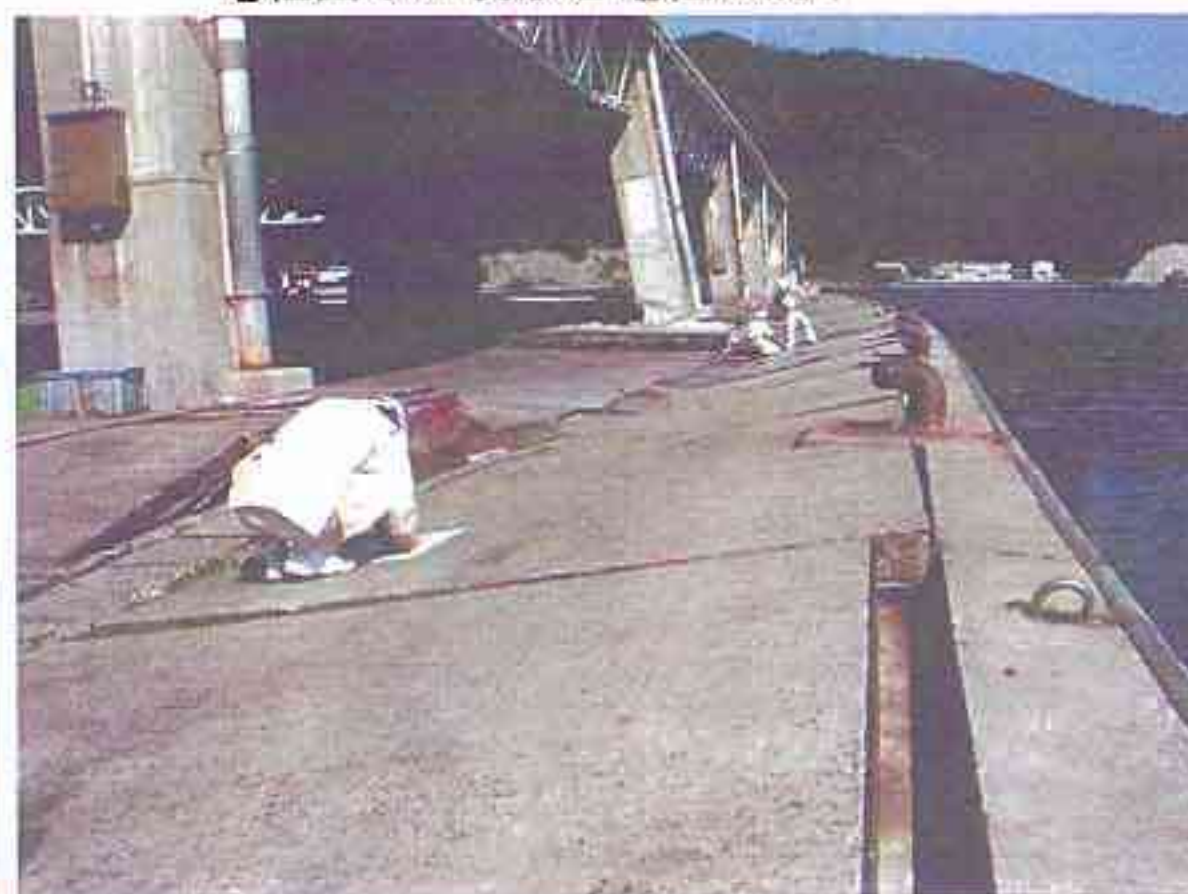
漁港突堤法線のはらみ出し
