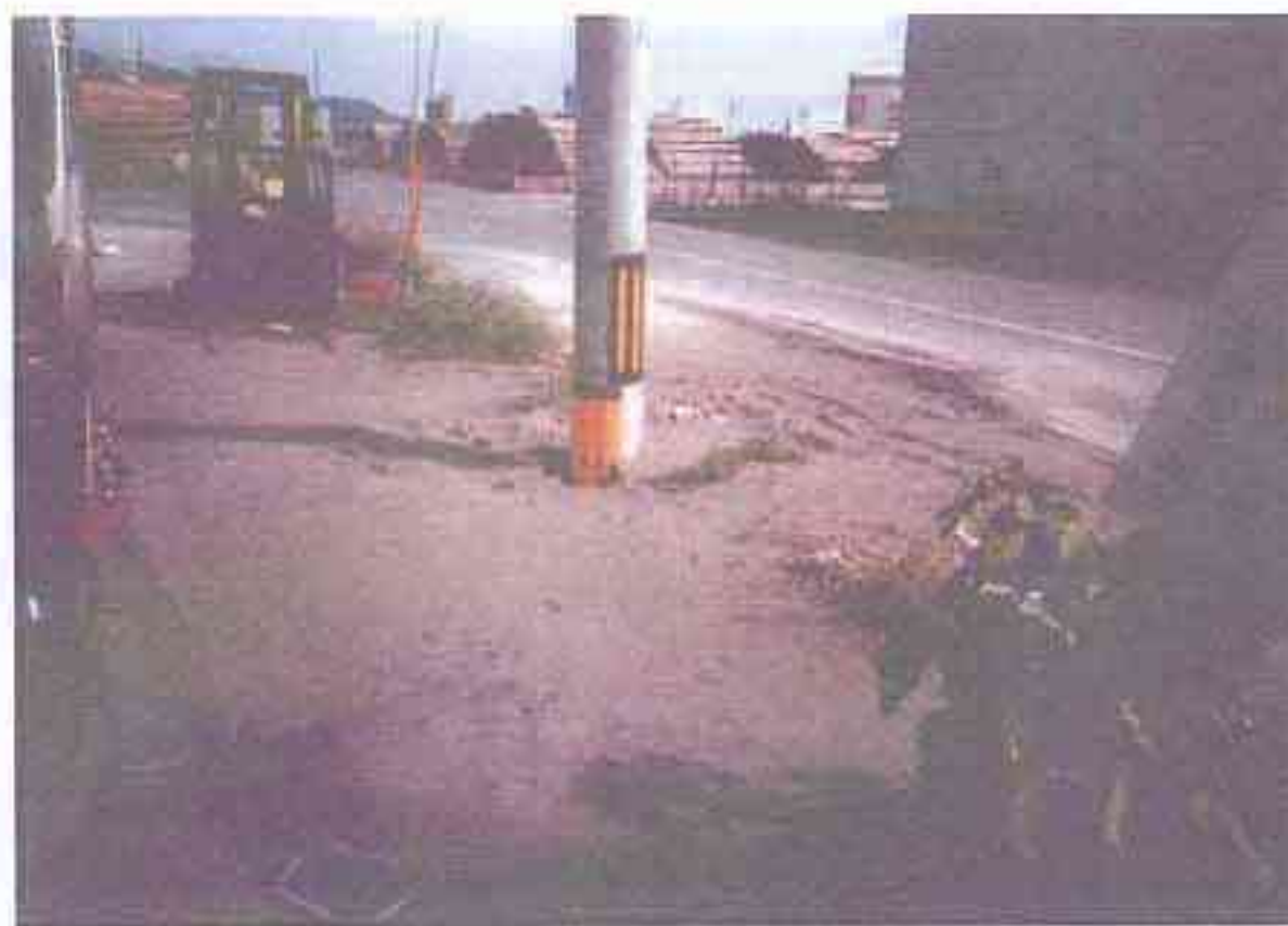
電柱回りの噴砂と電柱の沈下
