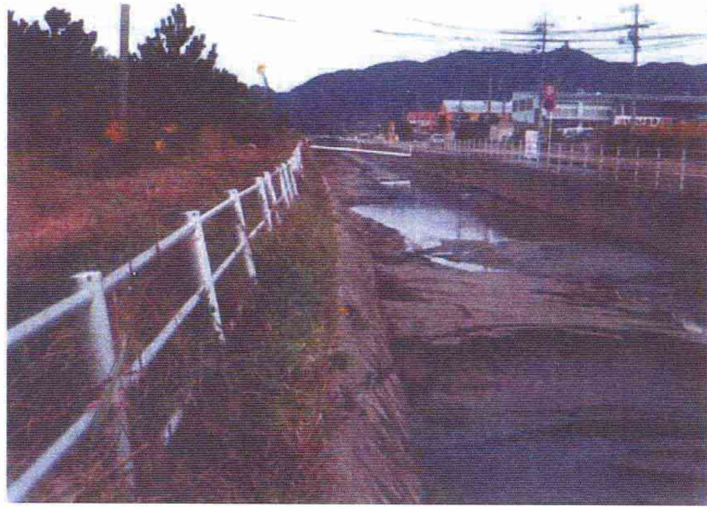
水路の両岸の護岸とも川側に押されている。川底は隆起し、その上に噴砂の砂が堆積している
