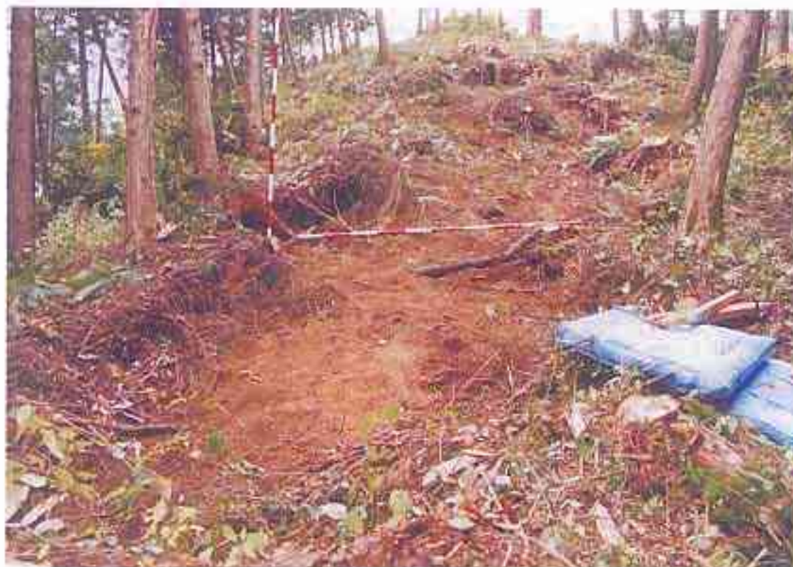
痩せ尾根沿いに発生した断裂亀裂
