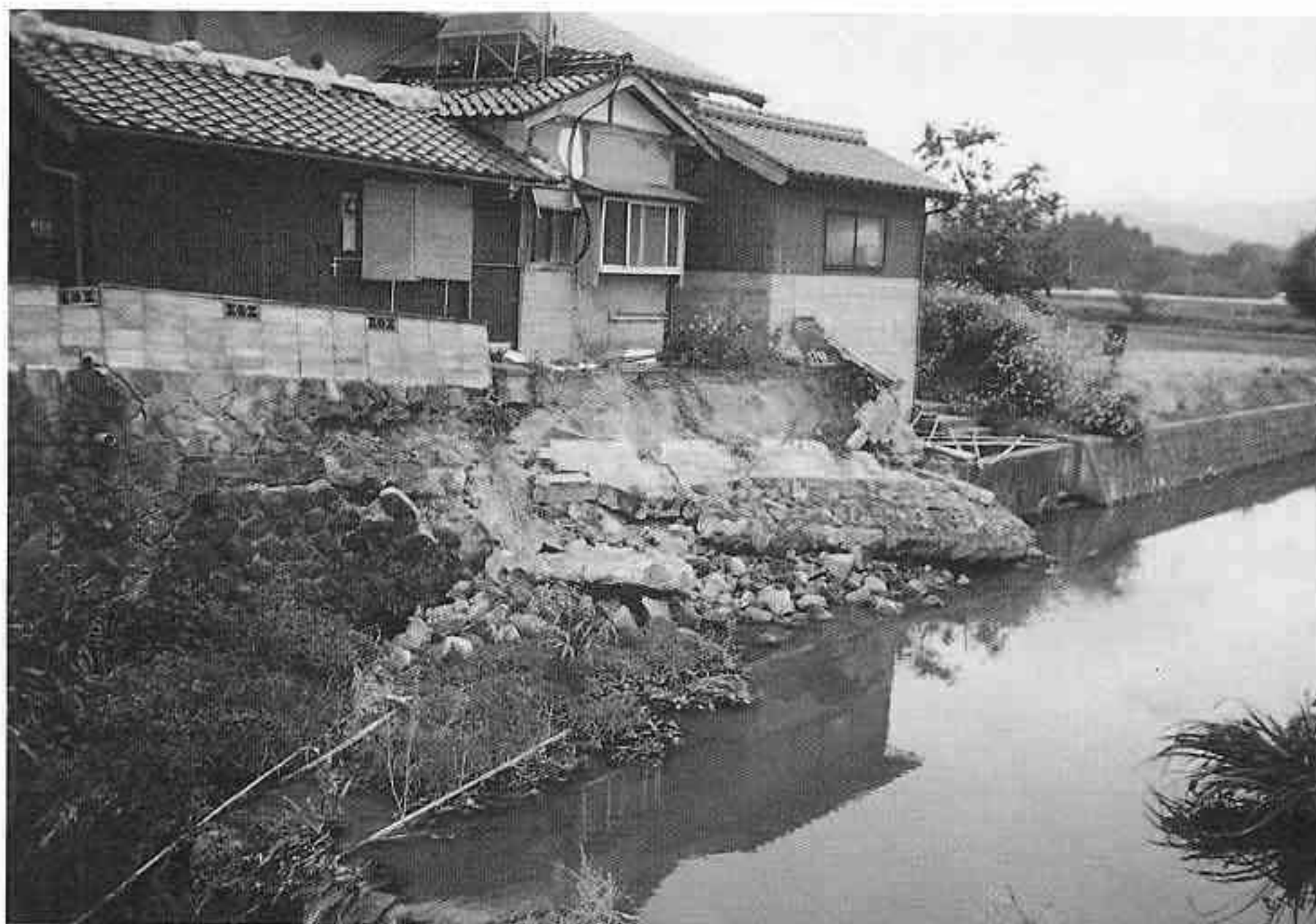
会見町市山 朝鍋川の護岸崩壊と民家の沈下
