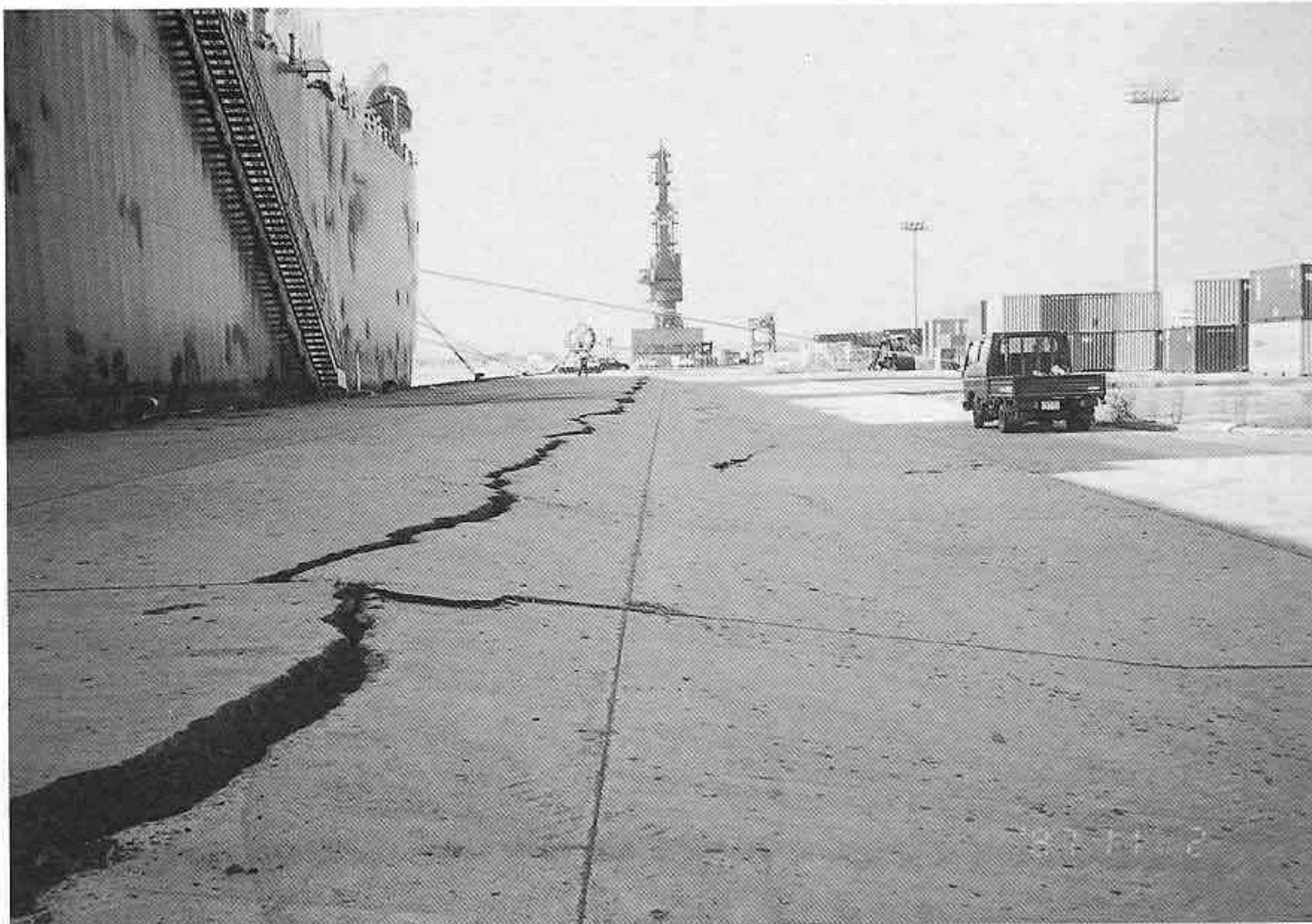
境港 昭和南-13m岸壁の段差
