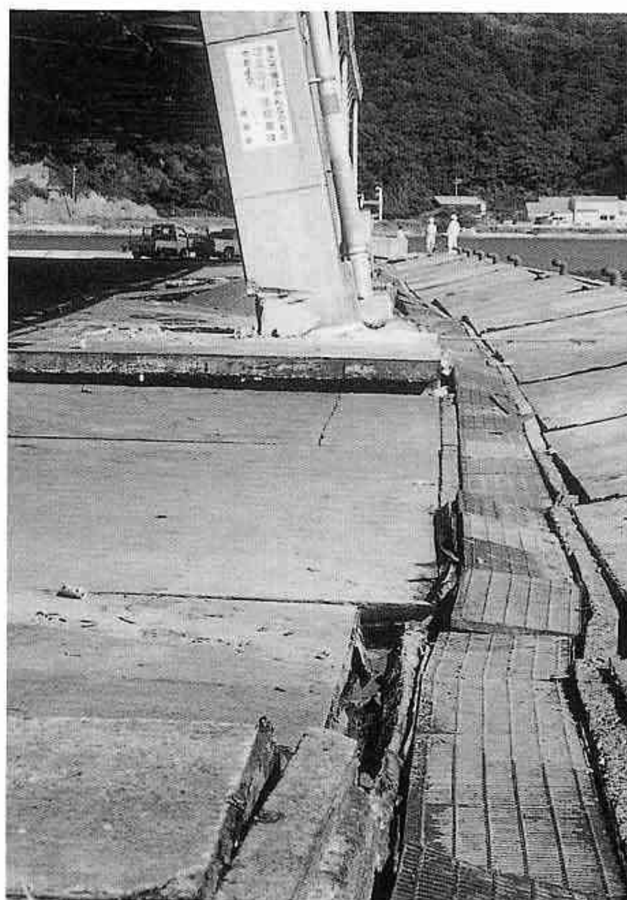
境漁港「かにかご岸壁」の被災状況
