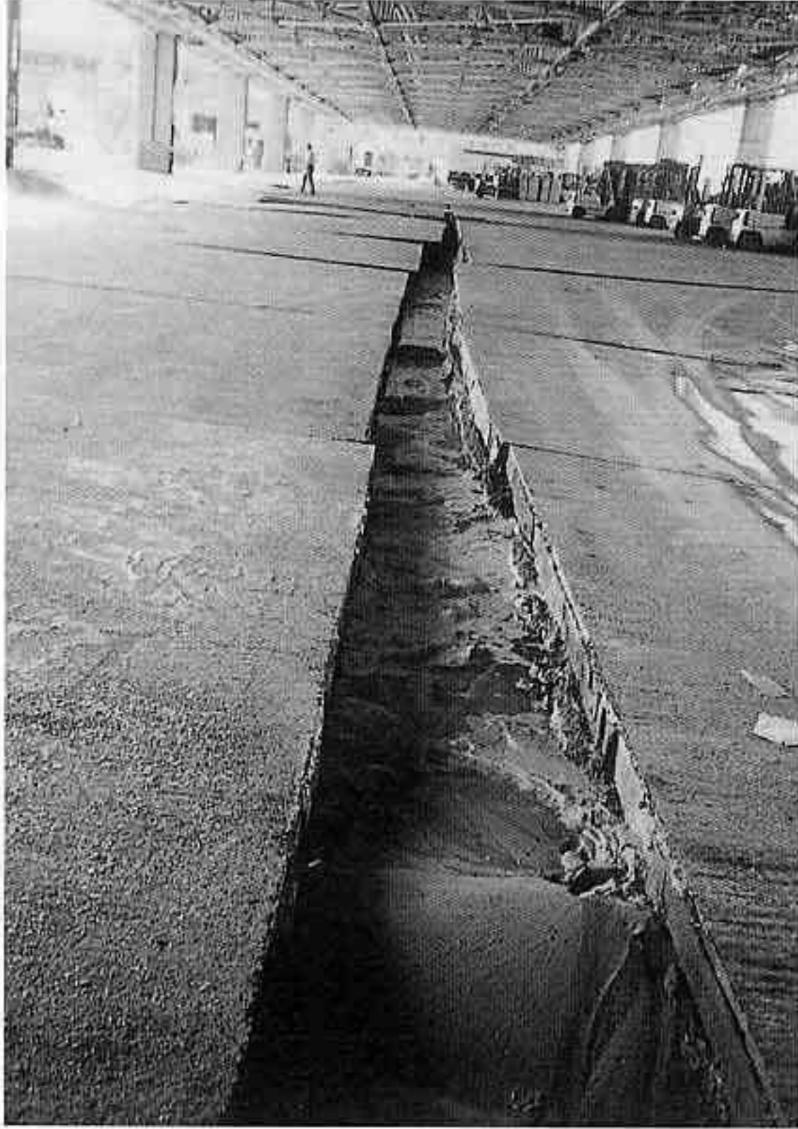
上屋床面の断裂状況（3号上屋）
