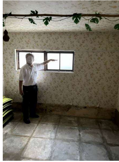
大雨で水没した地下岩盤浴施設(旅館B)
