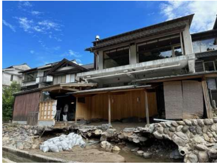
増水した河川に流された露天風呂(旅館A)
