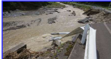
取水箇所の崩落 (鳥取市河内(とっとりしこうち))
