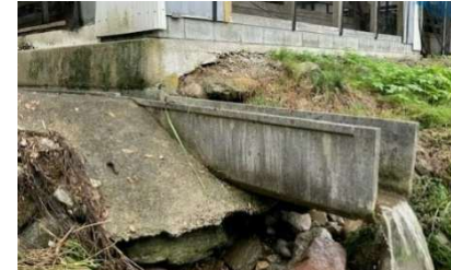
牛舎敷地内への河川流入による側溝基礎崩壊 (鳥取市河原町(とっとりしかわはらちょう))
