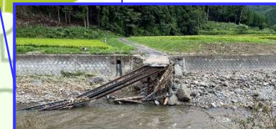
農道橋の流出 (八頭町落岩(やずちょうおちいわ))
