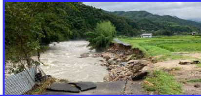
農道の崩落 (三朝町助谷(みささちょうすけだに))
