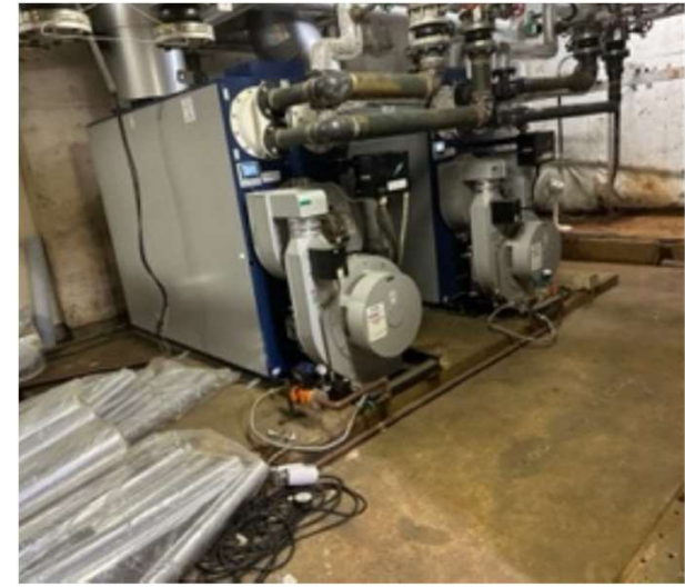
水没して被害を受けたボイラー(旅館C)
