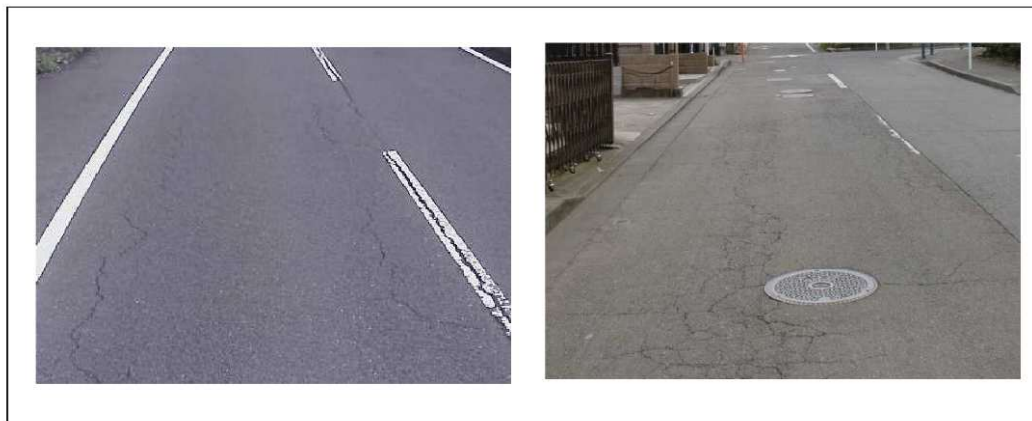
損傷レベル中 ひび割れ率 20~40%
