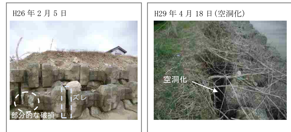
図 2-7 消波（被覆）ブロックのズレ、空洞化の状況（アングル④）
