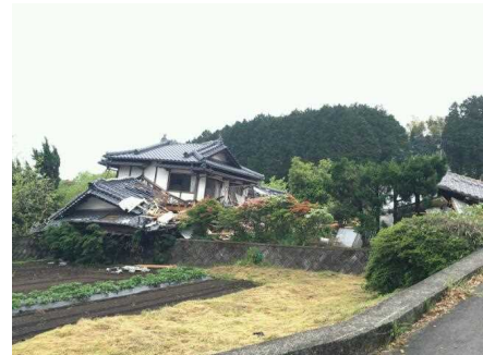
熊本地震の被災状況
