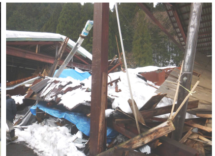
倒壊した製材所(智頭町)
