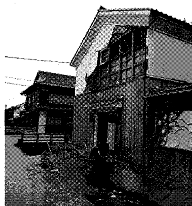
漆喰壁が崩落した倉吉白壁土蔵群
