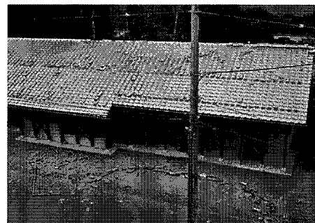
崩落した瓦（倉吉農業高）
