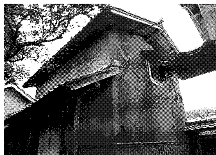
蔵の外壁が壊れた尾崎家住宅（湯梨浜町）
